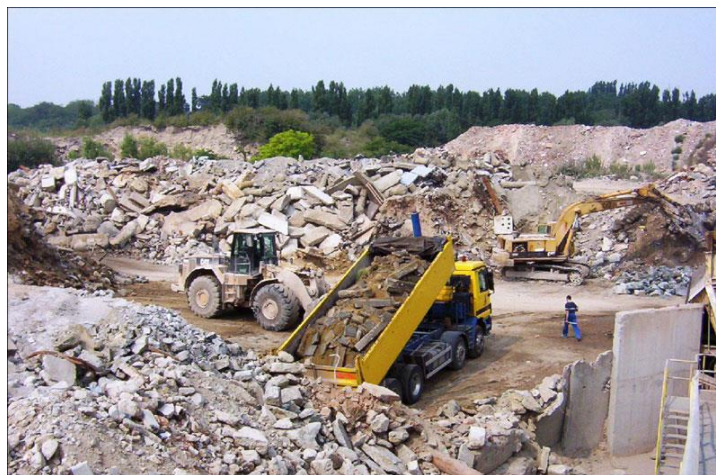
Obr. č.8 – Skládka stavebního odpadu [36].
