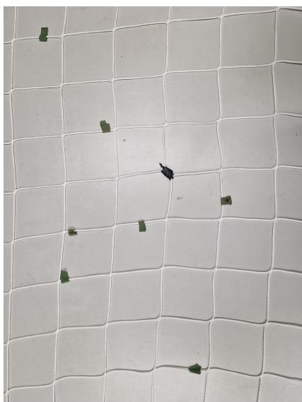
(a) Síť s vyznačenými poškozeními
