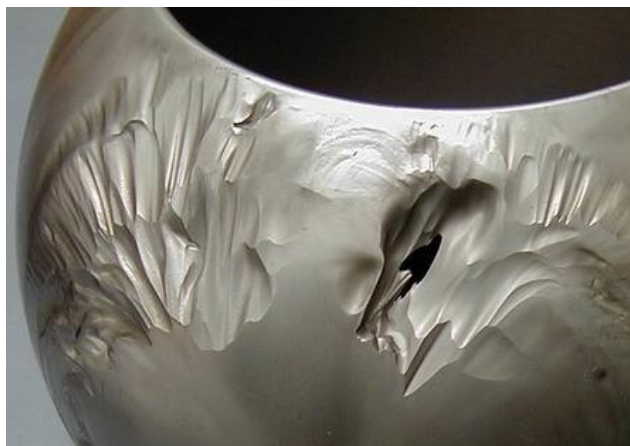
Obrázek 6 - Erozivně opotřebený uzávěr ventilu [29]
