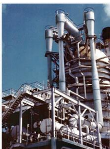
Obr. 2.7 – Tři paralelní ejektory na vakuové koloně pro destilaci ropných zbytků (ústí do kondenzátorů v dolní části obrázku) od firmy Graham [22]
