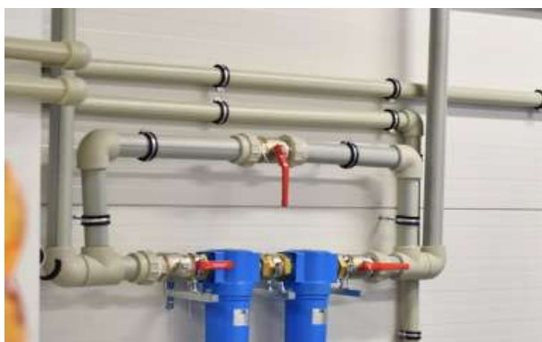
Obrázek 12 - Svařované plastové potrubí [13]
