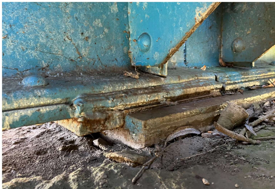
Obrázek 19: Pohled na znečištěné a zkorodované tangenciální ložisko [2]
