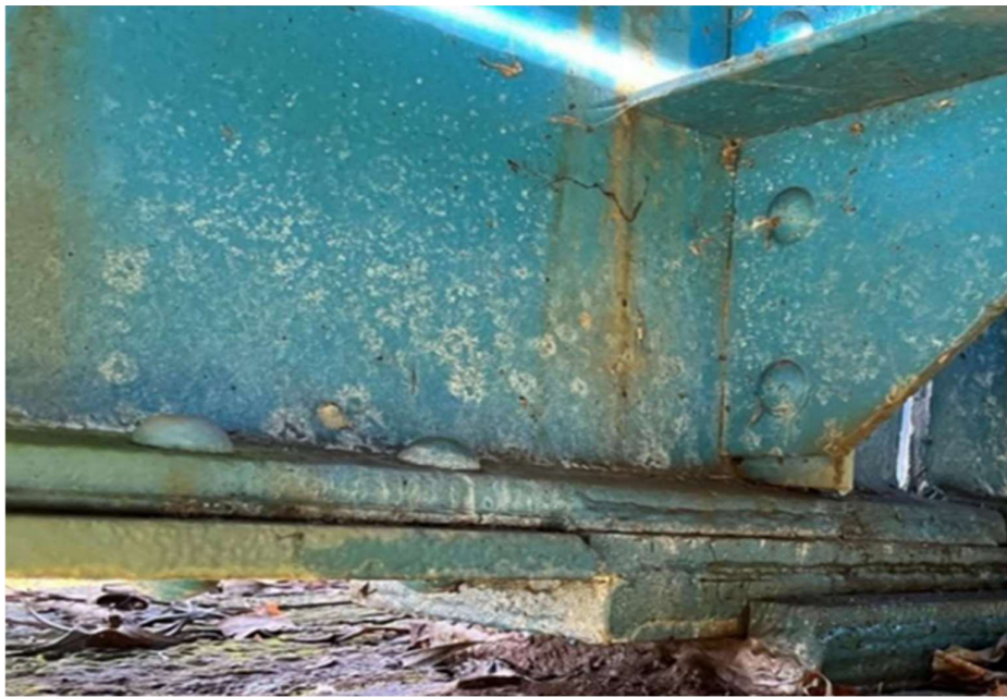
Obrázek 14: Znečištěný hlavní nosník konstrukce K04 [2]
