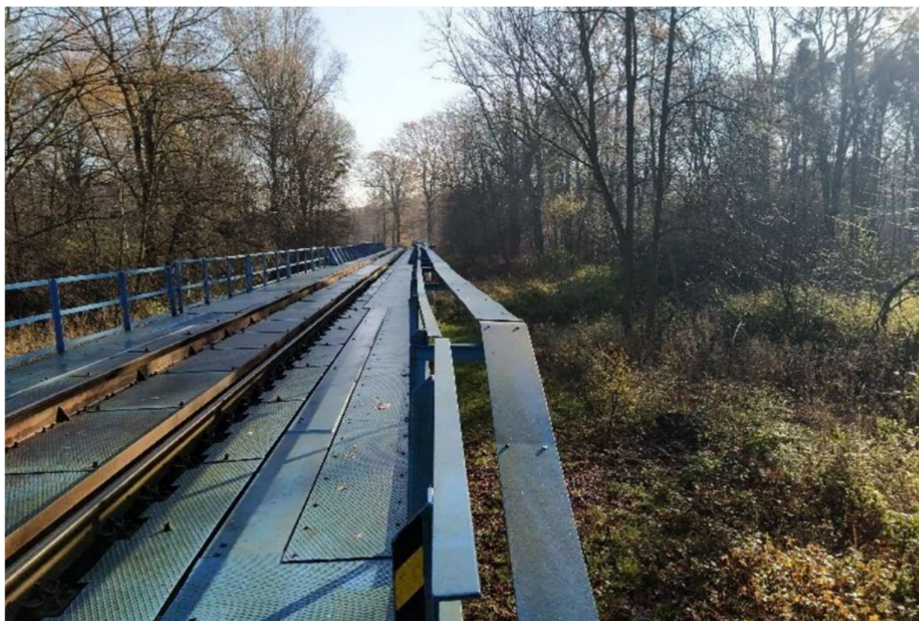
Obrázek 20: Podélná deformace zábradlí [2]
