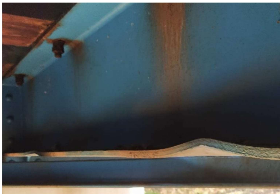
Obrázek 9: Plastická deformace dolní pásnice levého podélníku [2]
