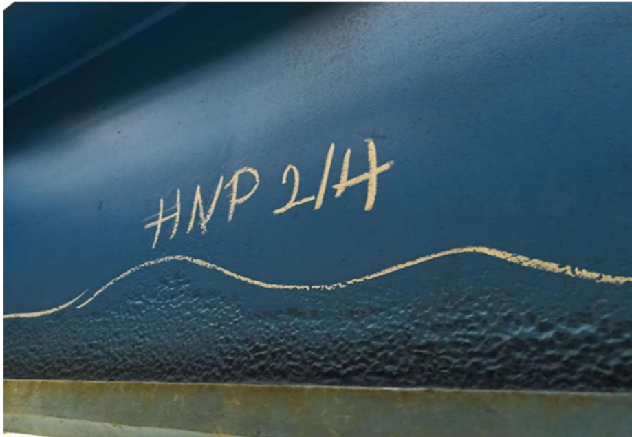
Obrázek 10: Důlkovité oslabení pravého hlavního nosníku [2]
