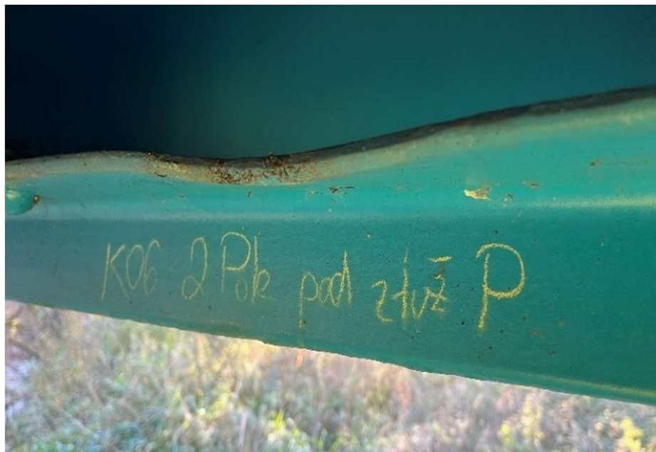
Obrázek 16: Plastická deformace vodorovného ztužení na K06 [2]
