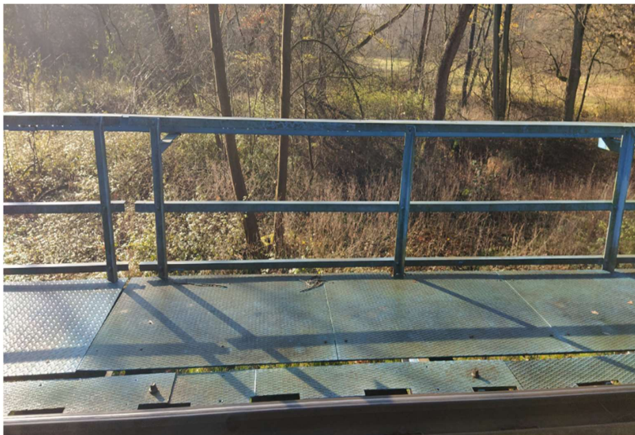
Obrázek 22: Znečištěné mostní vybavení [2]
