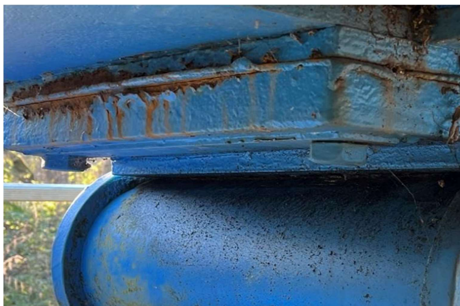
Obrázek 17: Odlupující se nátěr PKO na pohyblivém ložisku P06 [2]
