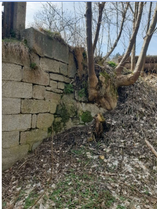
Obr. 6: Křídlo opěry O1 prorostlé vegetací
