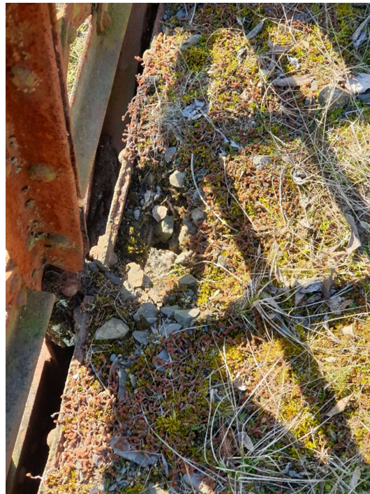
Obr. 19: Propadlá vozovka u pravého nosníku
