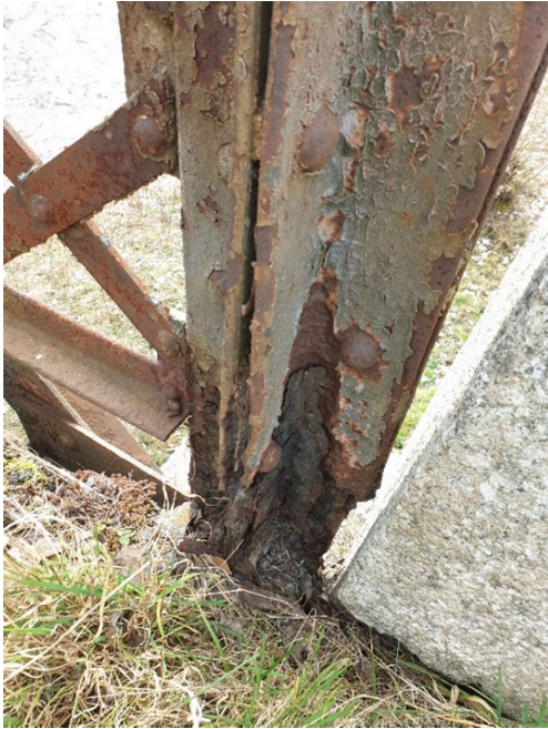
Obr. 9: Korozně oslabená svislíce č. 0 vpravo
