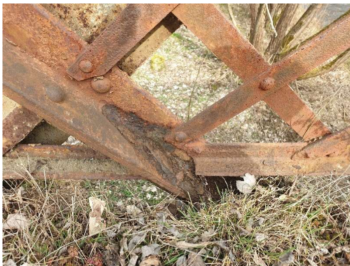
Obr. 14: Korozní oslabení úhelníku diagonály o 20 %
