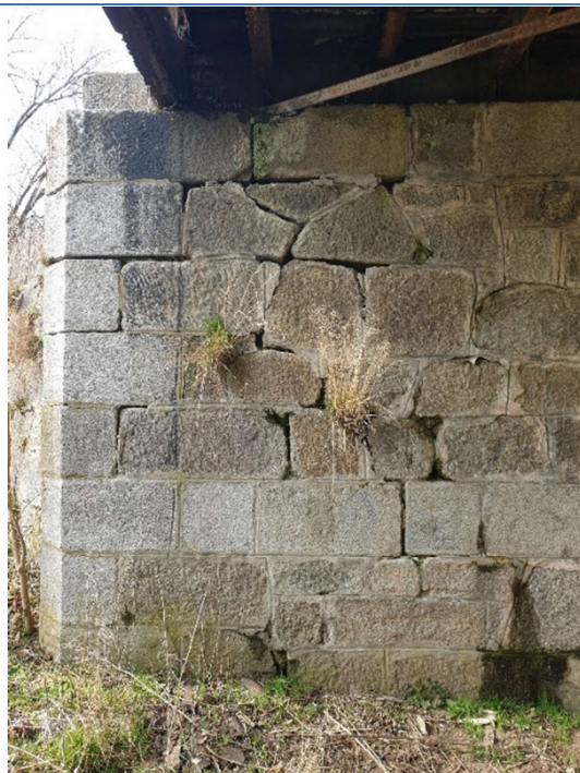
Obr. 7: Trhliny a rozvolněné zdivo opěry O1
