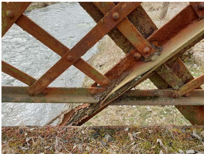
Obr. 13: Štěrbínová koroze a úplné prorezavění diagonály
