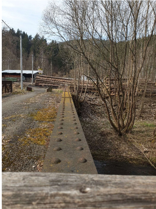
Obr. 15: Vybočení horního pásu levého nosníku
