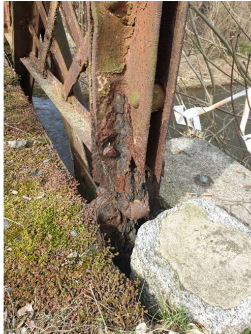
Obr. 10: Korozně oslabená svislíce č. 10 vlevo
