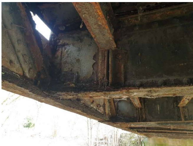
Obr. 17: Příčník se zkorodovanou dolní pásnicí
