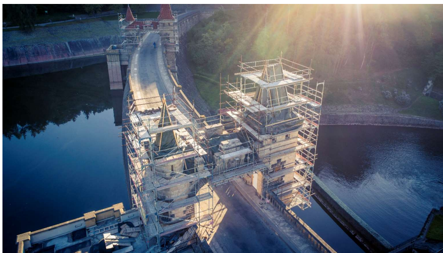
Obrázek 19 - Pohled z dronu na těleso hráze a průjezdovou bránu na koruně hráze při rekonstrukci (zdroj: Ladislav Válek, přehrada-les-kralovstvi.cz)
