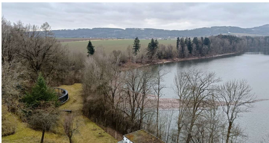
Obrázek 15 - Pohled ze šoupátkové věže na pravém břehu na pravý šachtový přeliv (zdroj: autorka práce)
