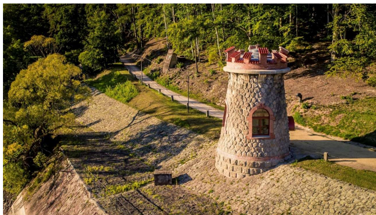
Obrázek 13 - Pohled z dronu na levou šoupátkovou věž po rekonstrukci v roce 2019 (zdroj: Ladislav Válek, přehrada-les-kralovstvi.cz)
