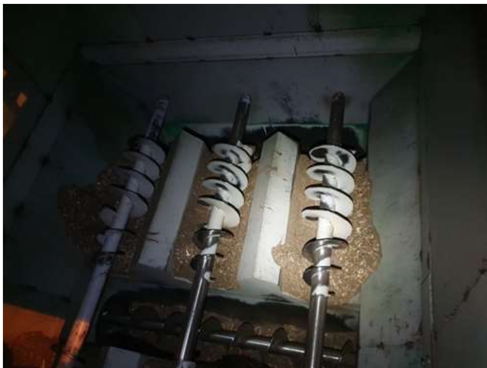
Obrázek 9: Vnitřek původního provozního zásobníku dřevní štěpky (dva vyhrnovačící šneky a pod nimi tři podávací šneky do pneumatického pohazovače do kotle)
