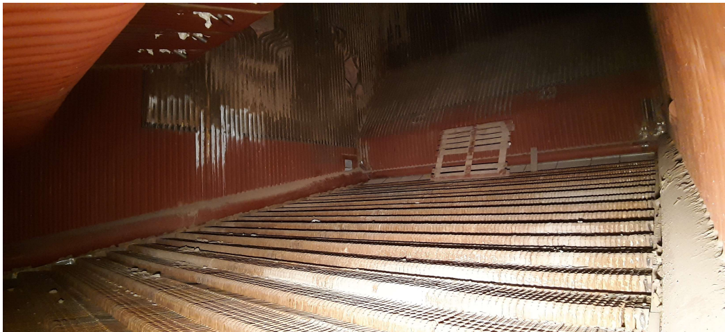
Obrázek 17: Vnitřek kotle a napojení membránové stěny
