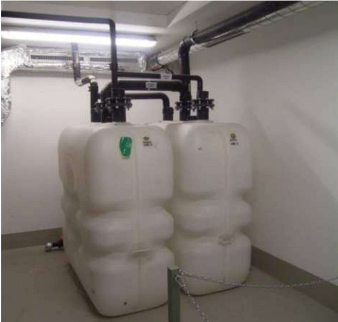
Obrázek 14: Nádrže na žlutou odpadní vodu [37]
