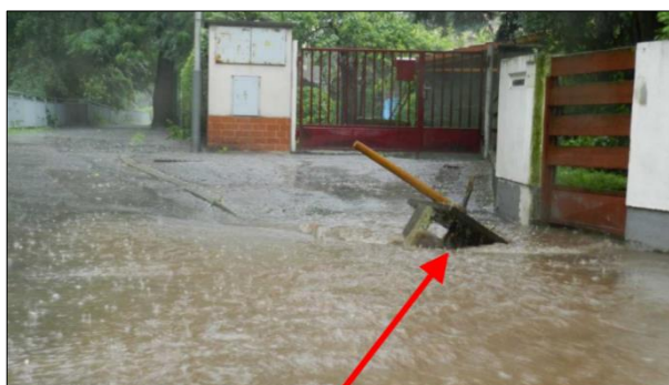
Obr. 4: Snížená kapacita uliční vpusti do kanalizace a nevhodné vyspádování komunikace [5]
