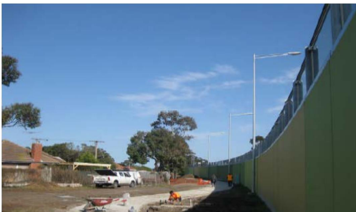
Obr. 12 Běžnou údržbu fotovoltaického systému lze provádět na straně protihlukové stěny mimo silnici [68]
