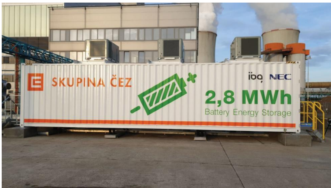
Obr. 18 Bateriové úložiště společnosti ČEZ v Tušimicích [80]
