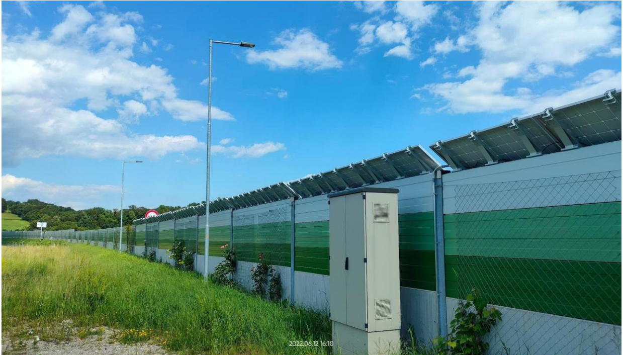
Obr. 36 Fotovoltaická protihluková stěna v Rakousku na silničním obchvatu města Wieselburg – venkovní rozvaděčová skříň se střídačem [autor]
