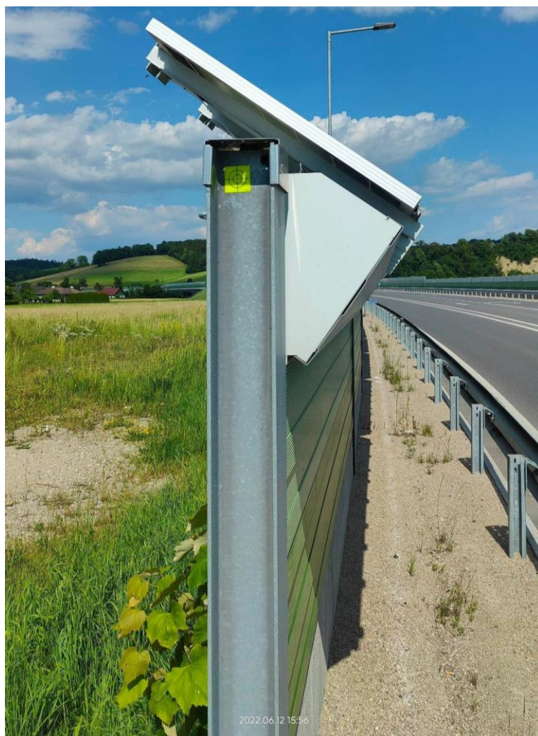
Obr. 35 Fotovoltaická protihluková stěna v Rakousku na silničním obchvatu města Wieselburg – kazetová konstrukce (typ 6) Forster FONOCON Silent Solar s FV moduly [autor]
