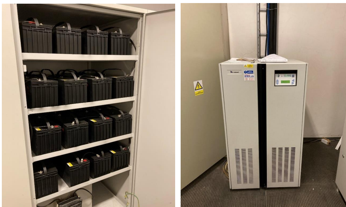
Obrázek 10 Zálohový systém pavilonu A2 s bateriovým boxem (Autor)
