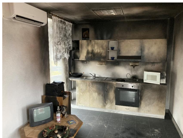
Obrázek 11 - Pohled na vyhořelou místnost [vlastní]
