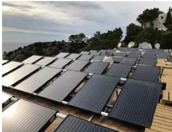
Obrázek 3.2 Zasklené kolektory v hotelu na Ibize na rovné střeše [2]
