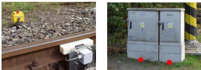
Obrázek 13 – kabelový objekt ZZ, kabelová skříň [1]
