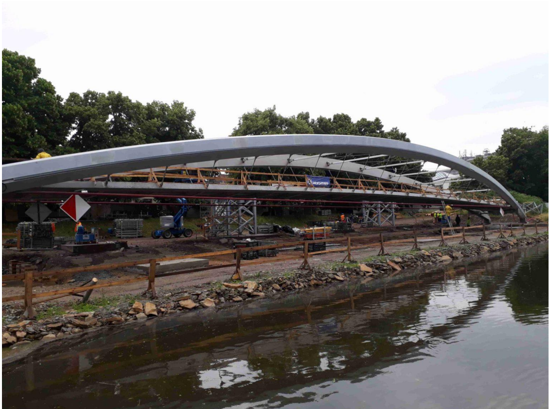
Obrázek 2.6 Dočasné táhlo oblouku v červené trubce
