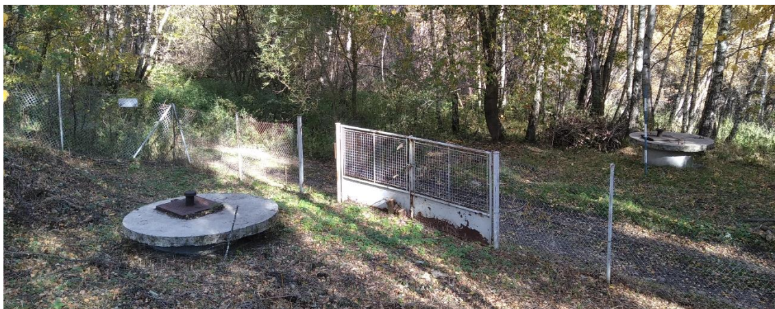
Obr. 23: Studny S1 a S2 v prameništi Třešňovice
