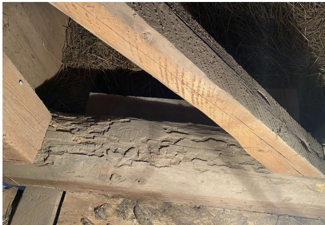
Obrázek 54- Krov – vazný trám napadený tesaříkem (značení 59)
