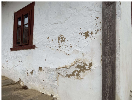
Obrázek 45– vyboulení a trhliny fasády – jih (značení 109)
