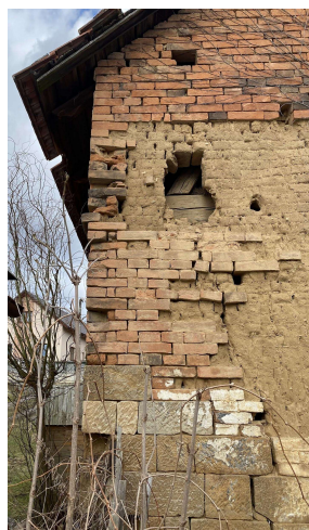
Obrázek 60- statická trhлина- exteriér – jih (značení 159)
