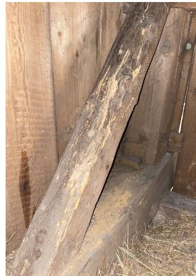
Obrázek 55- Krov – vazný trám a rozpěra napadena tesaříkem (značení 73)
