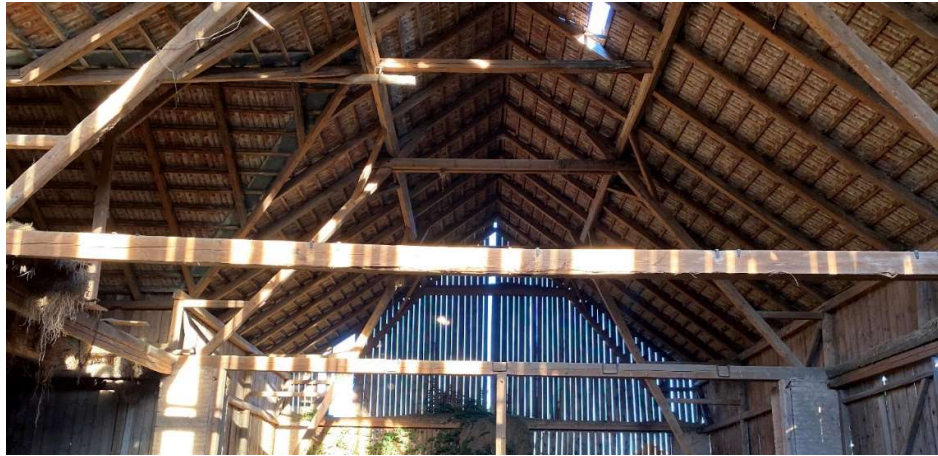
Obrázek 38– krov – východ (značení č.15)
