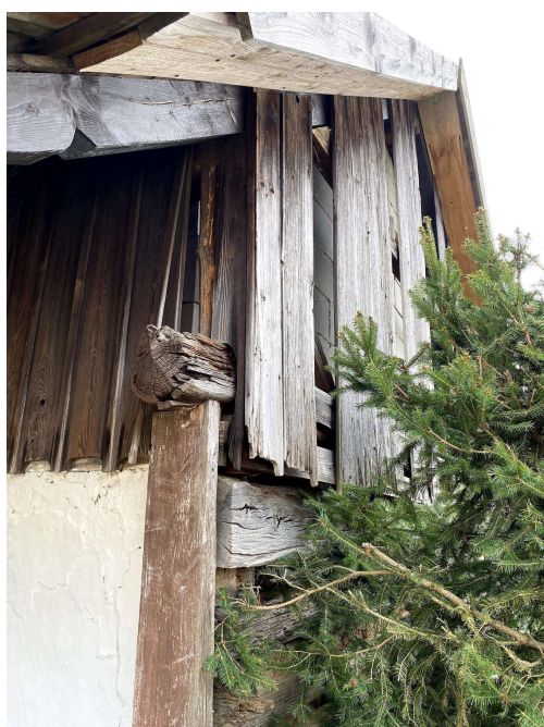
Obrázek 57- poškození štít– západ (značení 129)
