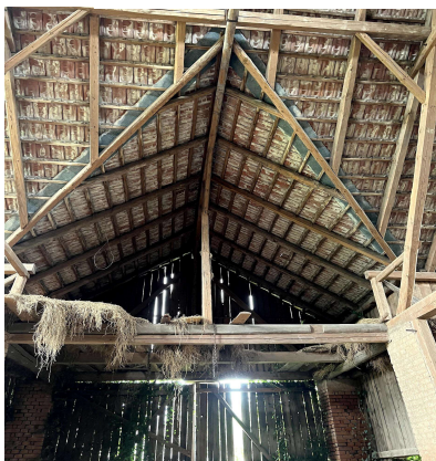
Obrázek 40– krov – sever (značení č.19)
