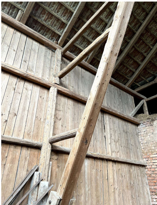
Obrázek 83- sloupy napadené tesaříkem (značení č.42)
