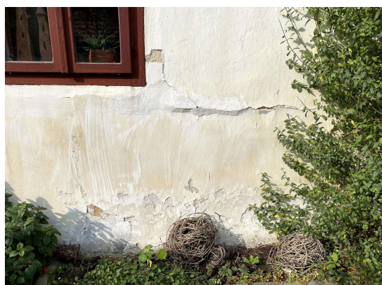
Obrázek 46– vyboulení a trhliny fasády – východ (značení 97)
