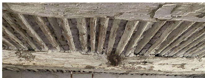
Obrázek 68- průhyb trámu (značení 177)
