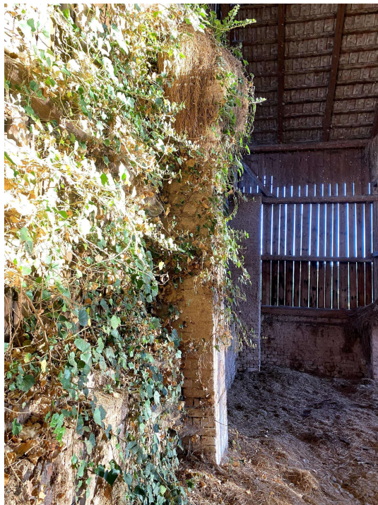
Obrázek 80- vybočení pilíře (značení č.35)
