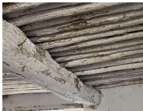
Obrázek 66- opadaná omítka stropu (značení 176)
