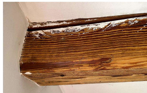
Obrázek 50– podélné trhliny – chodba (značení 40)
