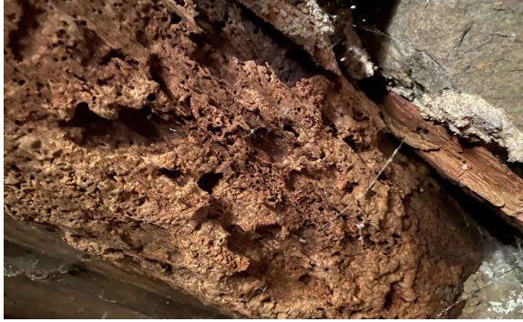
Obrázek 53- Sklep – trám napadený tesaříkem (značení 13)
