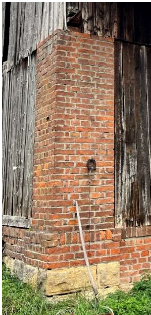
Obrázek 37– rohový pilíř – jih (značení č.9)
