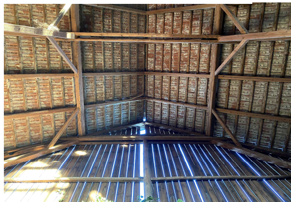
Obrázek 39– krov – východ (značení č.17)
