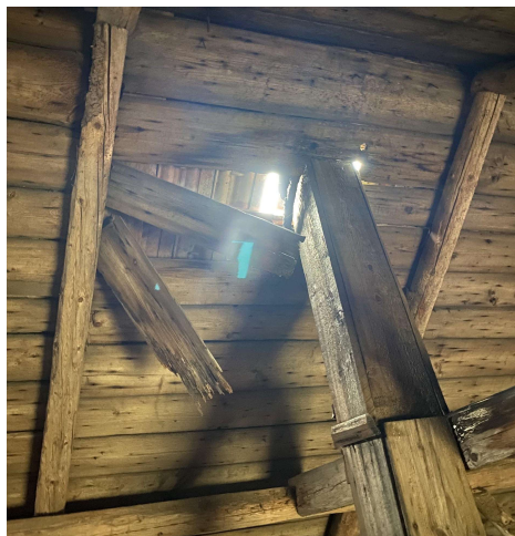
Obrázek 69- porušení střešního pláště (značení 185)
