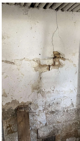
Obrázek 61- statická trhлина- interiér – jih (značení 178)
