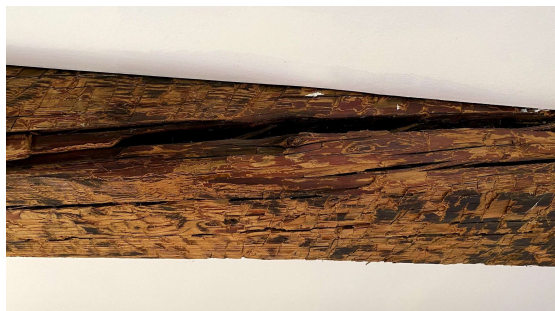
Obrázek 51– podélné trhliny – přední místnost (značení 32)
