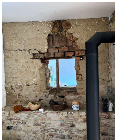
Obrázek 47– vodorovné trhliny (značení 35)
