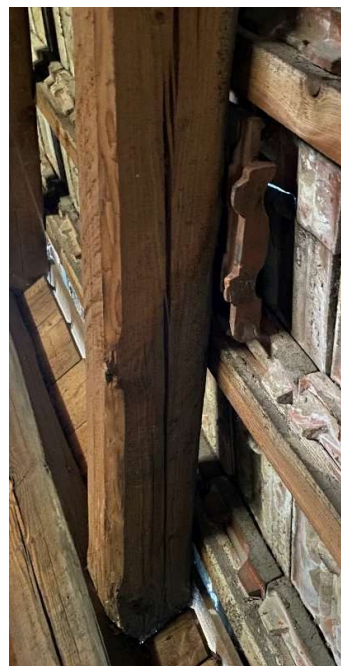
Obrázek 58- Krov – porušení tašek – sever
