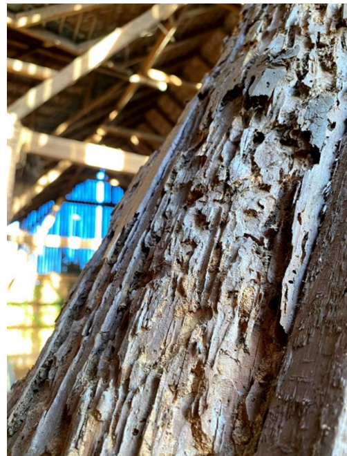
Obrázek 81- sloupek napadený tesaříkem – detail (značení č.43)
