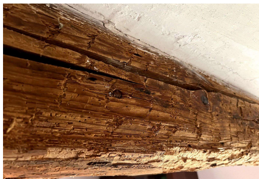
Obrázek 49– podélné trhliny a napadení červotočem (značení 44)
