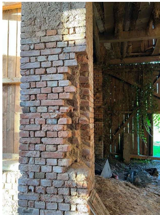
Obrázek 79- porušený pilíř a vypadané cihly (značení č.28)
