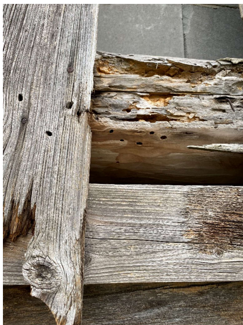
Obrázek 56- poškození štít– západ
