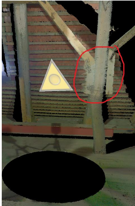
Obr. 27: Chybná naskenovaná data – na sloupku
