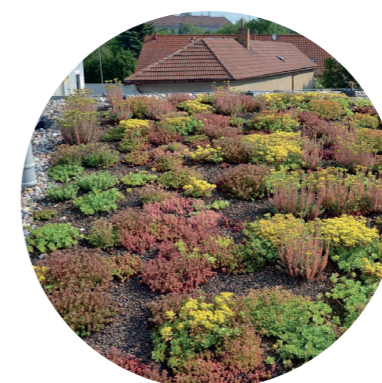
EXTENZIVNÍ ZELENÁ STŘECHA – pažitka pobřežní – kociánek dvoudomý – tařice skalní – rožec plstnatý – hvozdík kartouzek – devaterník velkokvětý
