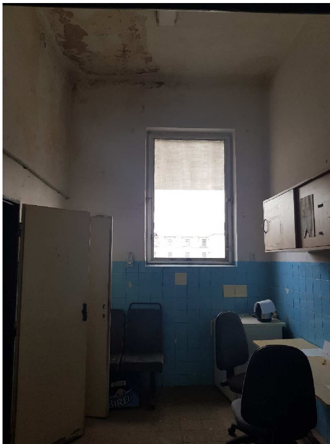
Obrázek 67: Stopy po zatékání – místnost 1.12
