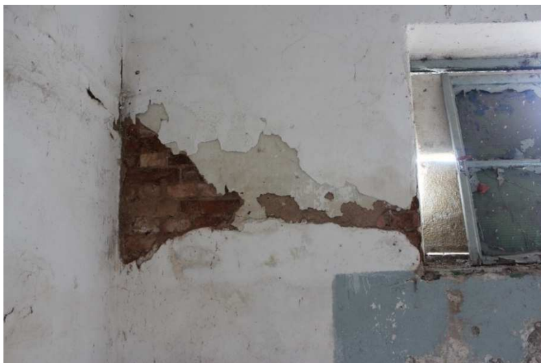
Obrázek 58: Poškozené zdivo – obvodová stěna
