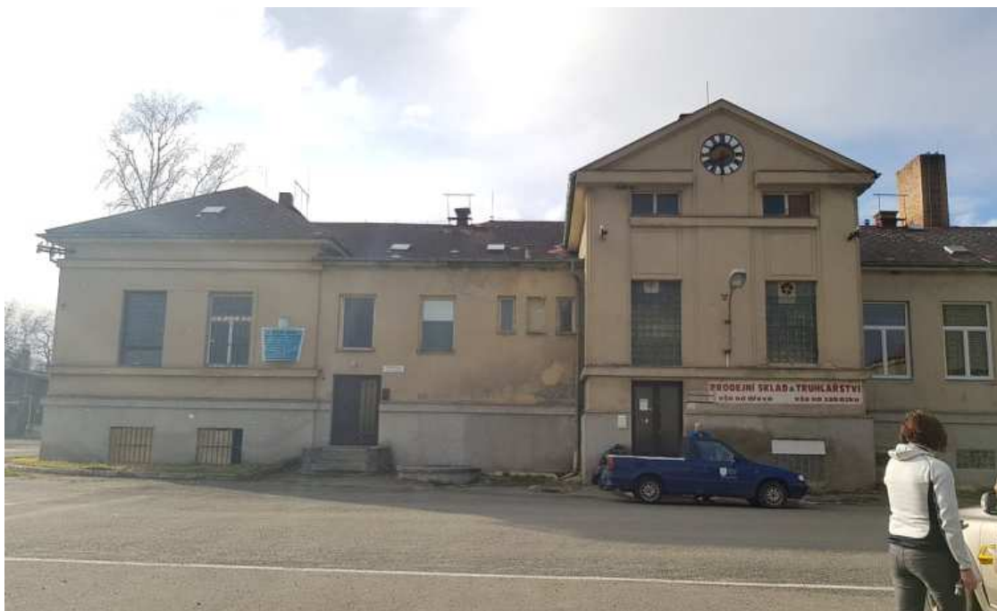
Obrázek 40: Pohled na přední stranu objektu – stávající stav oken
