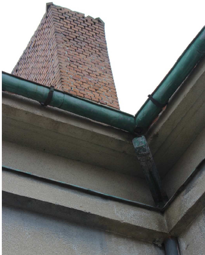
Obrázek 60: Poškozené komínové těleso
