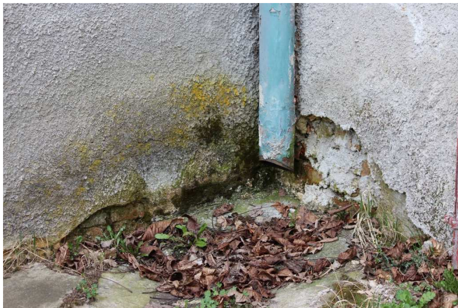
Obrázek 71: Detail poškození omítky – roh hlavní věže objektu
