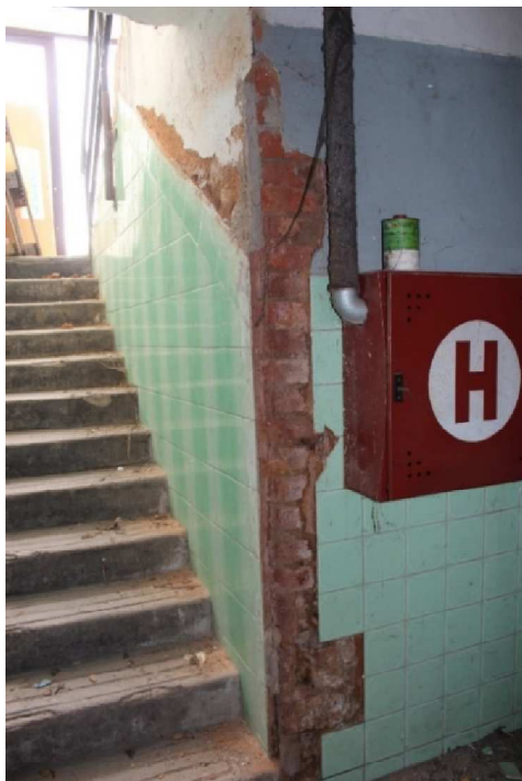
Obrázek 55: Poškozené zdivo – schodiště
