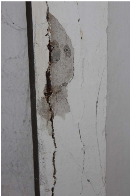
Obrázek 61: Poškozený žb trámek – místnost 0.01
