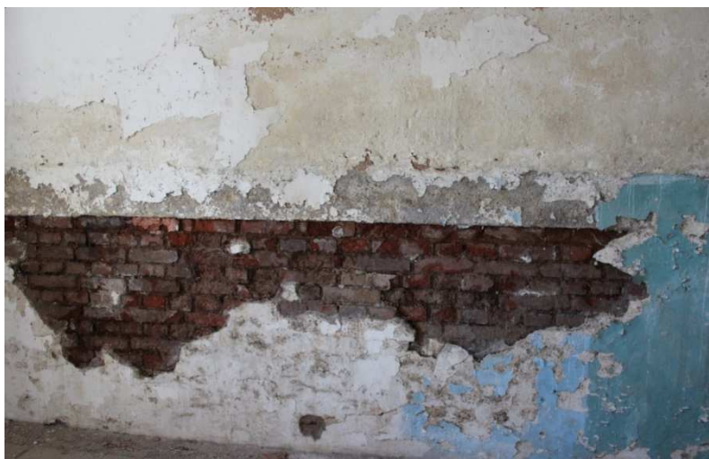
Obrázek 57: Poškozené zdivo – Jižní obvodová stěna
