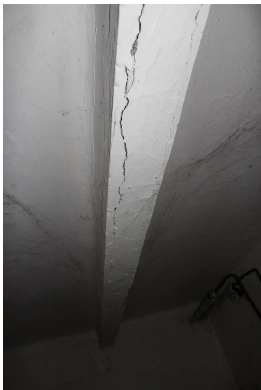
Obrázek 63: Pohled na žb trámek – místnost 0.01
