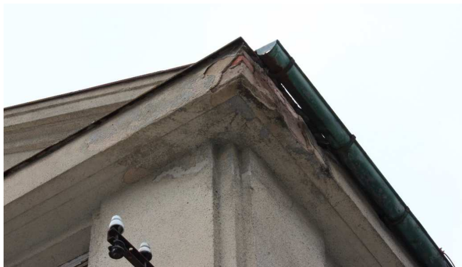
Obrázek 72: Poškozená římsa – severní roh hlavní věže
