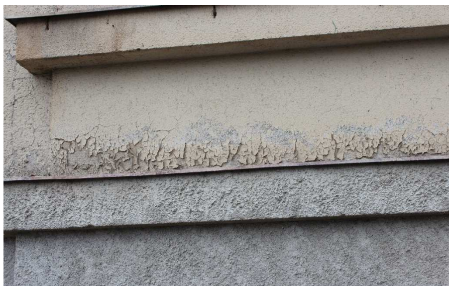
Obrázek 73: Poškozená omítka v důsledku odšťikující srážkové vody
