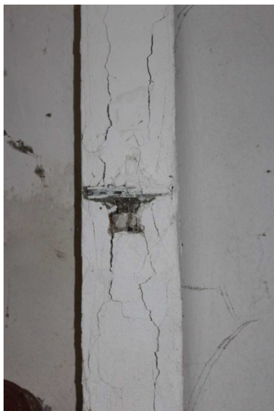
Obrázek 64: Poškozený žb trámek – místnost 0.07
