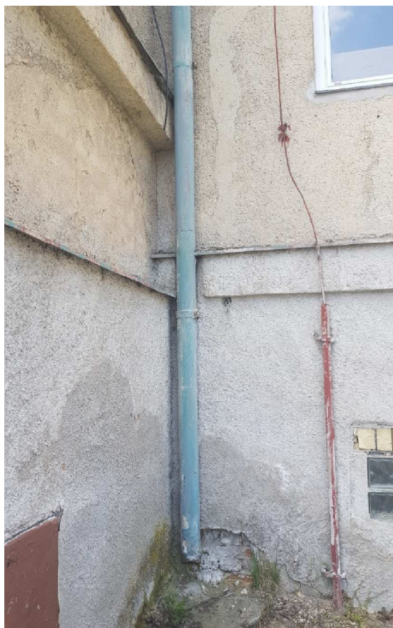
Obrázek 70: Poškozená fasáda od dešťových svodů – roh hlavní věže objektu
