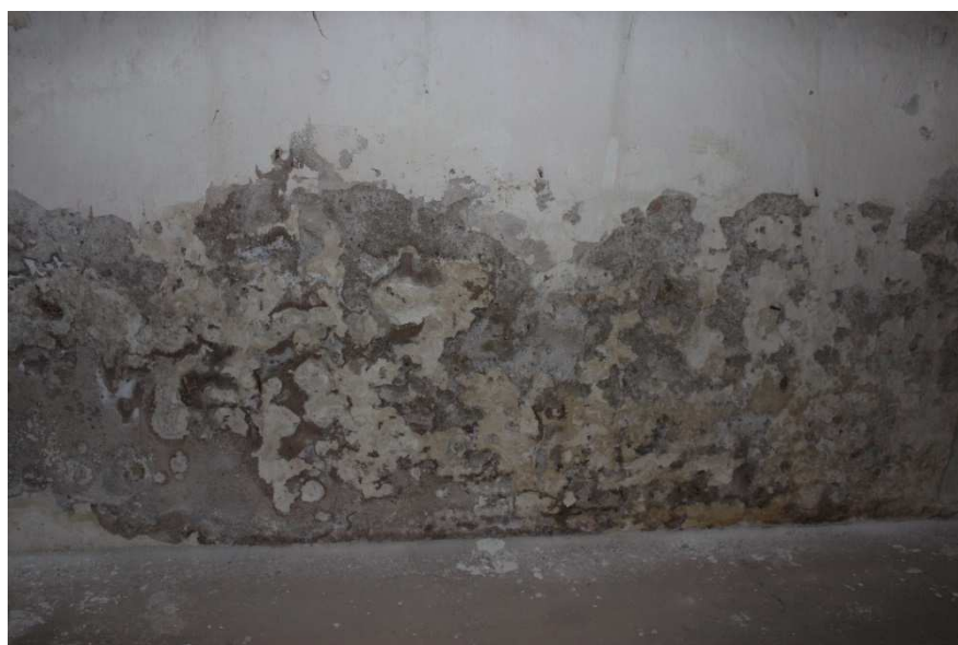
Obrázek 76: Degradované suterénní zdivo
