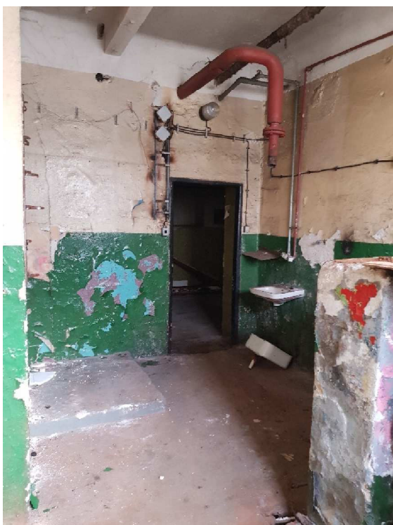
Obrázek 36: Stěny s omyvatelným nátěrem – technická místnost
