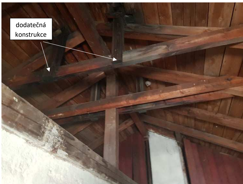
Obrázek 66: Oslabené místo krovu
