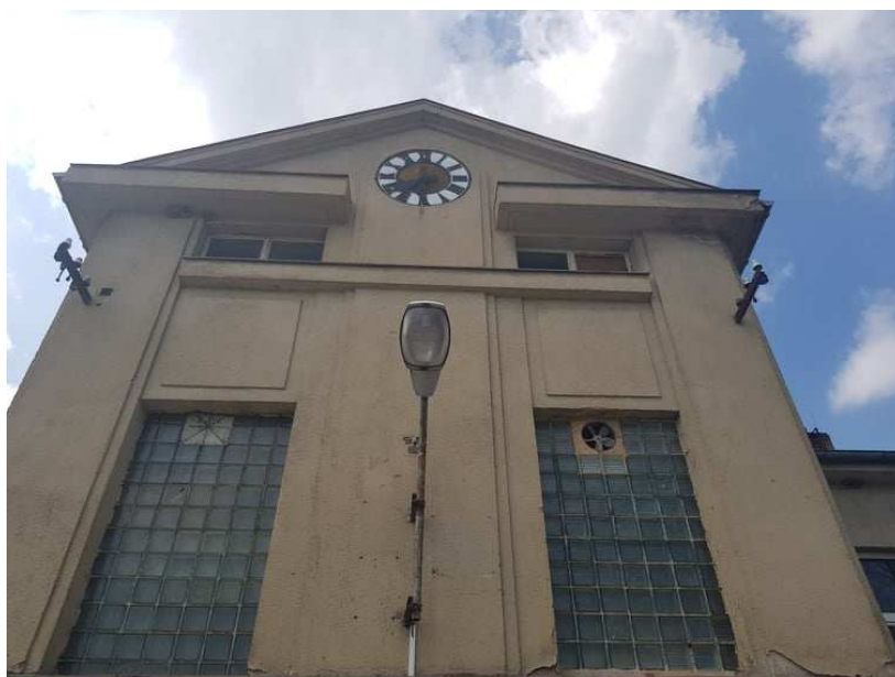
Obrázek 38: Poslední původní dochovaná okna v objektu
