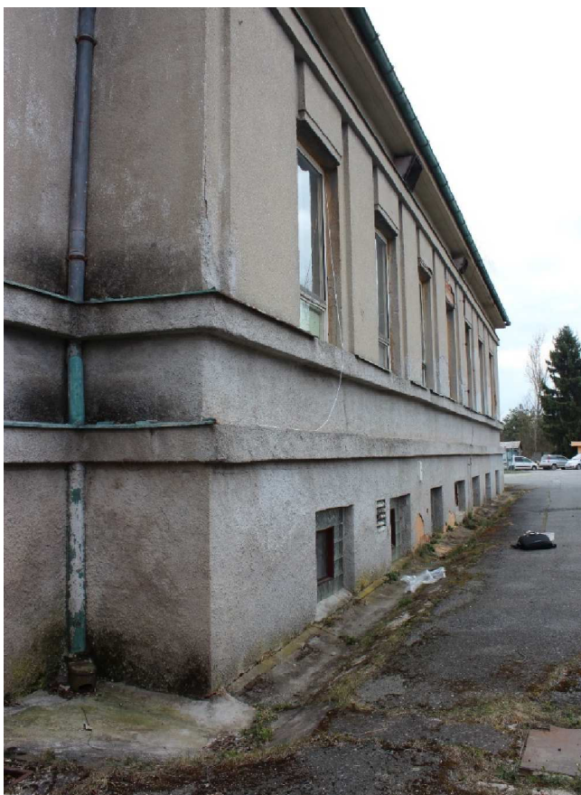
Obrázek 69: Poškozená fasáda od dešťových svodů – západní strana objektu
