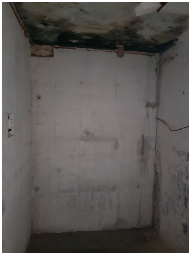
Obrázek 68: Plísně nacházející se na povrchu stropní konstrukce – místnost 0.19
