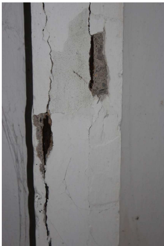
Obrázek 62: Poškozený žb trámek – místnost 0.02
