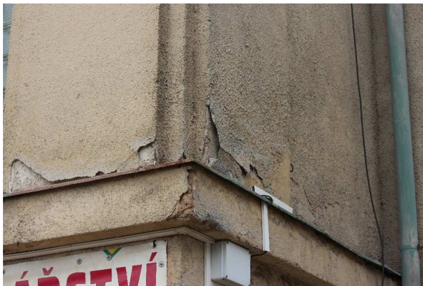
Obrázek 74: Poškozená omítka v důsledku odstříkující vody –roh hlavní věže
