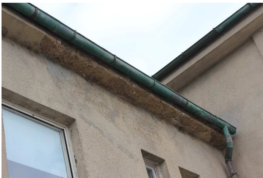
Obrázek 75: Omítka poškozená v důsledku nefunkčních dešťových žlabů
