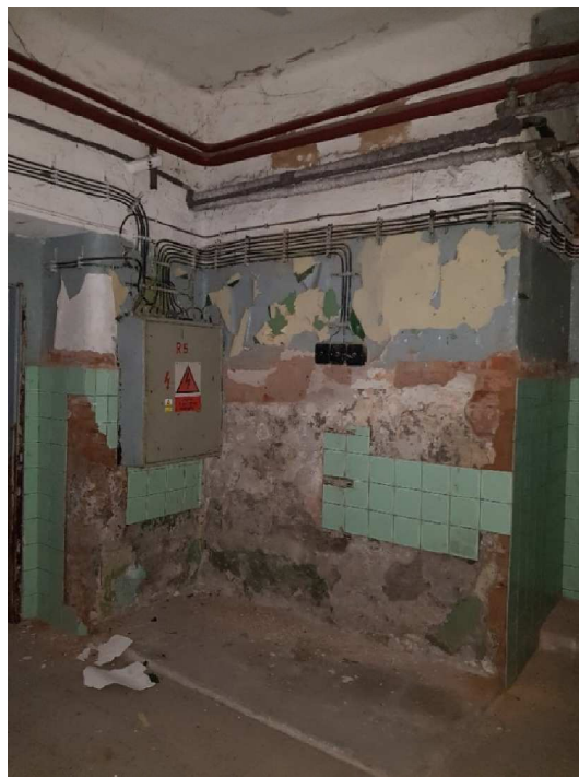
Obrázek 56: Poškozené zdivo – vnitřní stěna
