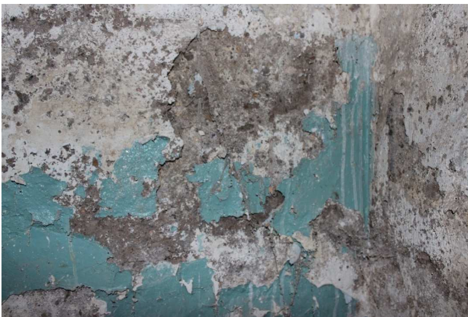
Obrázek 77: Poškozené omítky s emailovým nátěrem
