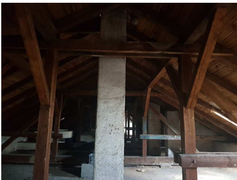
Obrázek 14: Pohled na odvětrávací těleso v půdním prostoru
