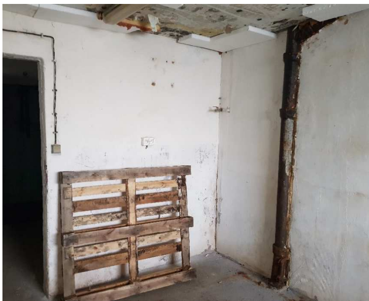
Obrázek 31: Pozůstatky nalepené tepelné izolace
