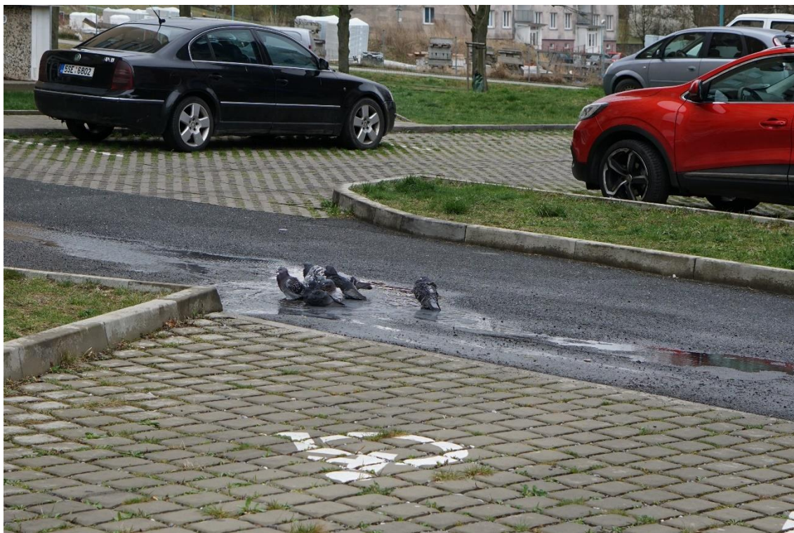
Obrázek 8 – stav drenážní a zatravněvací dlažby po vytrvalém dešti svědčí o dobrých podmínkách pro vsakování
