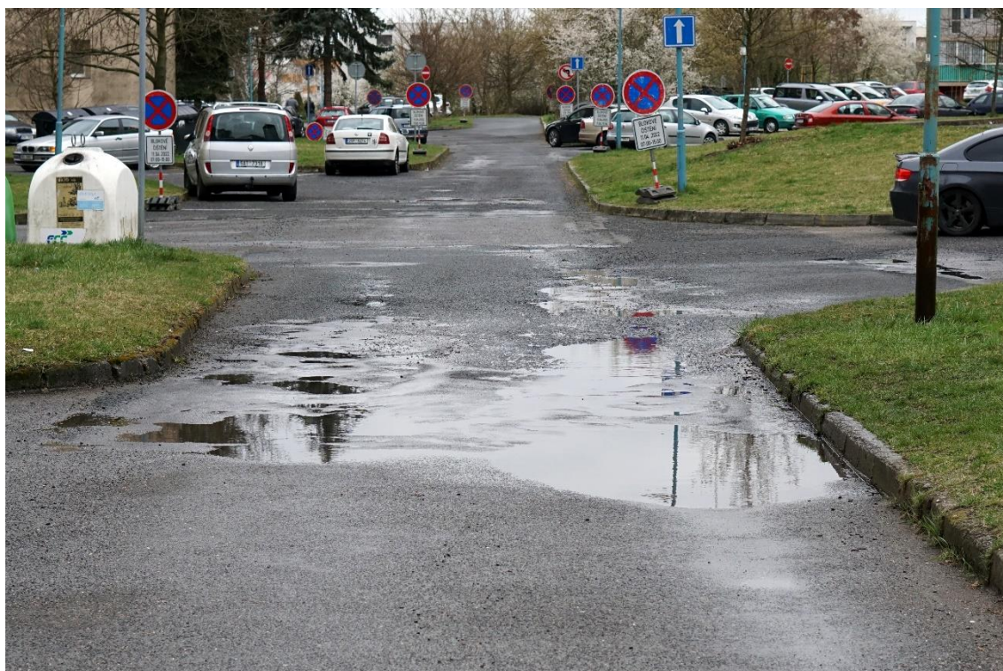
Obrázek 2 – v polovině Průběžné ulice (patrné problematické odvodnění)
