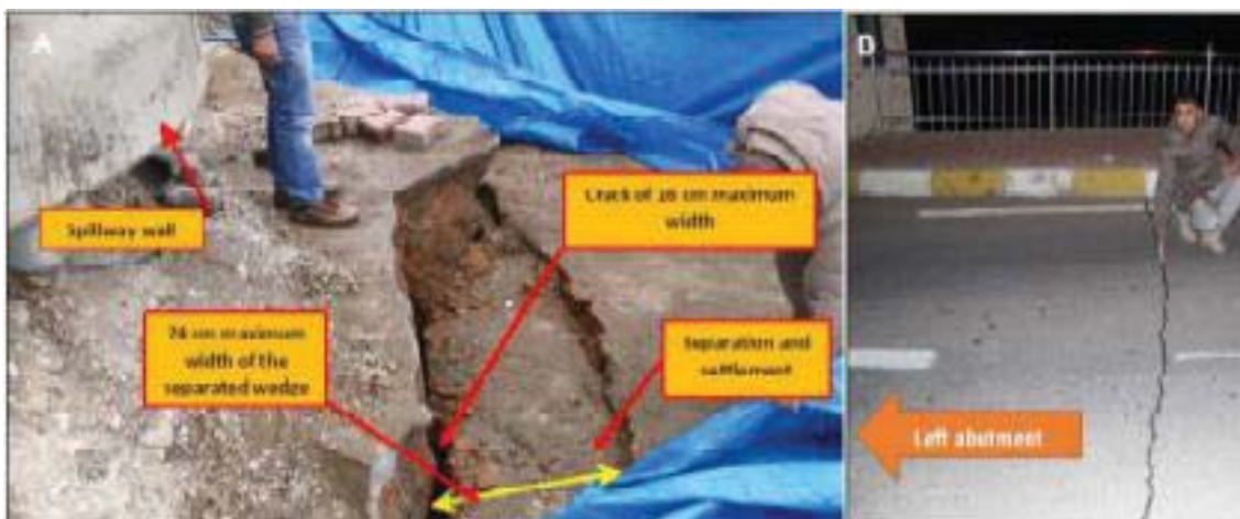
Obrázek 19. Příčné trhliny po zemětřesení [28]
