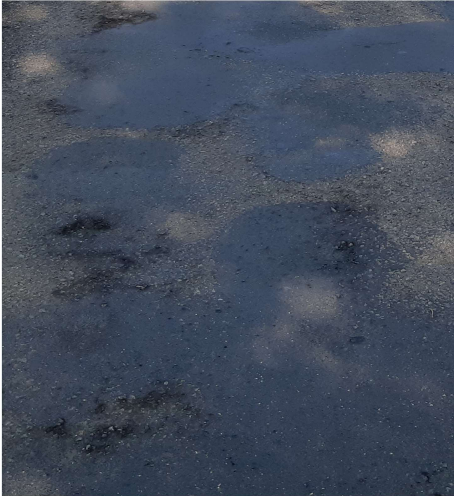
Obr.5 – Detail poškození vozovky
