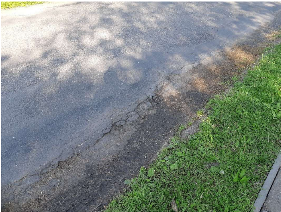
Obr.6 – Detail poškození vozovky
