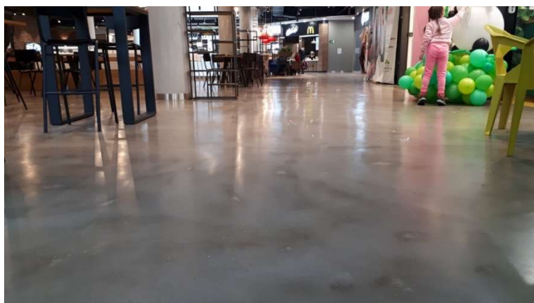
Obr. 13 - Impregnovaná betonová podlaha v OC Stromovka [18]
