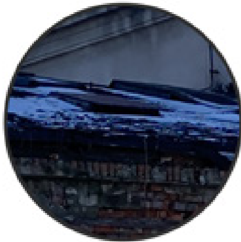
nefunkční střešní krytina
