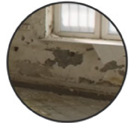
degradovaná vnitřní omítka
