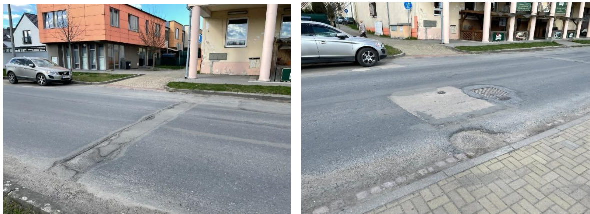
Obrázek 19: Stav povrchu vozovky (zdroj: autor)
