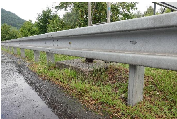
Obrázek 80 – Vyčnívajcí betonový základ SDZ v blízkosti hlavní silnice.
