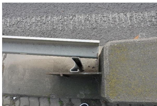
Obrázek 150 – Detailní pohled na chybně realizované napojení ocelového svodidla.
