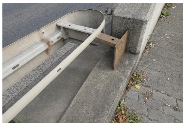
Obrázek 142 – Detailní pohled na chybně realizované napojení ocelového svodidla.
