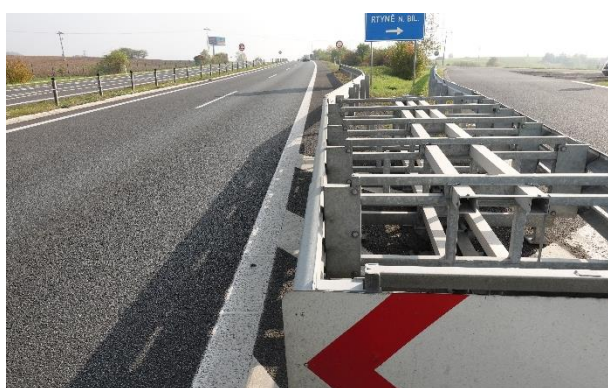
Obrázek 125 – Vzdálenost tlumiče nárazu od VDZ V 4 na hlavní PK je pouze 0,5 m.
