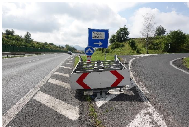
Obrázek 114 – Detailní pohled na tlumič nárazu v dopravním ostrůvku MÚK.
