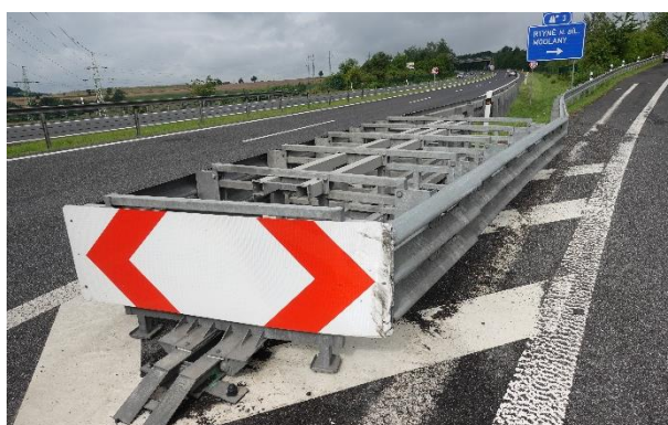
Obrázek 132 – Poškozený první segment tlumiče.
