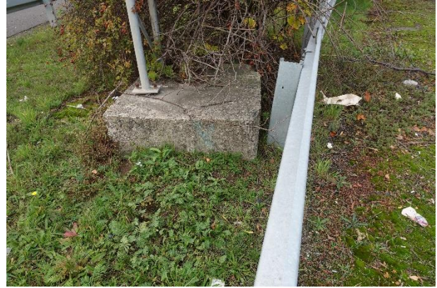
Obrázek 81 – Vyčnívajcí betonový základ SDZ v blízkosti větve MÚK.
