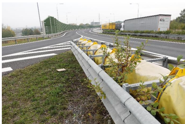
Obrázek 9 – Ukázka zeleně rostoucí v konstrukci tlumiče nárazu.
