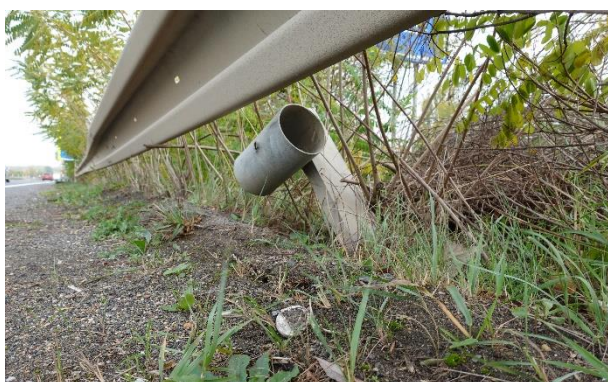
Obrázek 61 – Další pohled na poškozené svodidlo.
