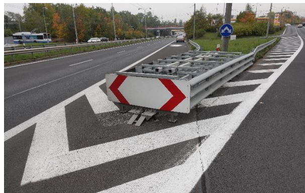
Obrázek 33 – Pohled na tlumič nárazu nacházející se v prostoru bezpečné zóny PK.
