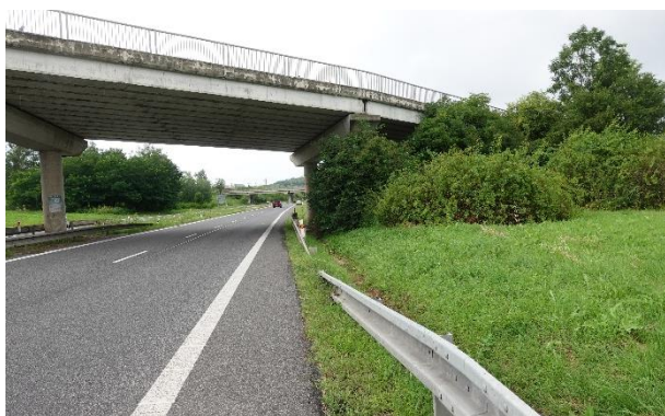
Obrázek 98 – Absence propojení nově osazených a stávajících svodidel.
