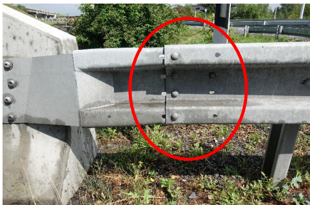
Obrázek 72 – V místě napojení přechodu na ocelové svodidlo chybí propojovací šrouby.
