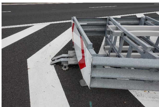
Obrázek 25 – Poškozený první segment tlumiče.
