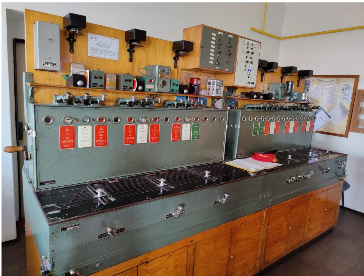
Obrázek 27 Panel zabezpečovacího zařízení v dopravní kanceláři, foto vlastní
