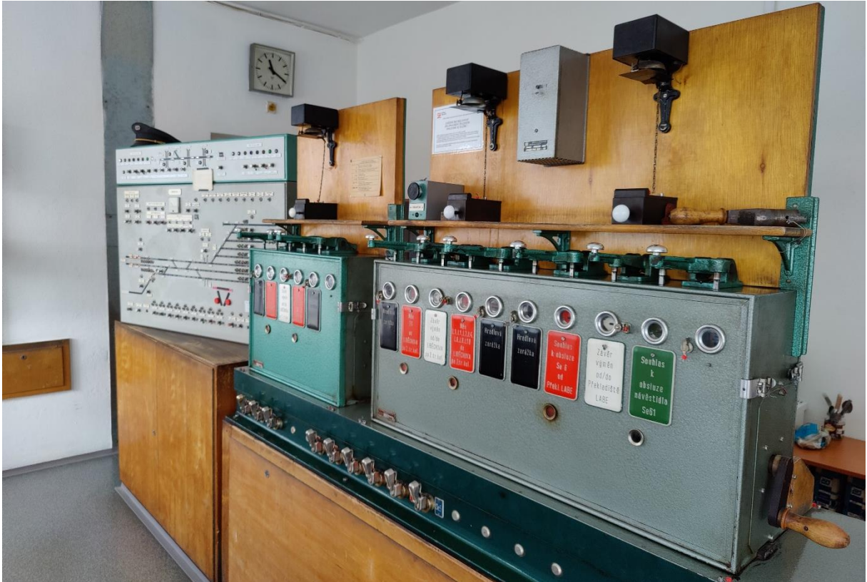
Obrázek 28 Panel zabezpečovacího zařízení na stavědle 2, foto vlastní
