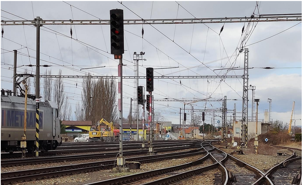
Obrázek 22 Pohled na odjezdová návěstidla ve směru Liběchov (zleva) L 8, L 4, L 2, L 6, L 3 a L 1, foto vlastní
