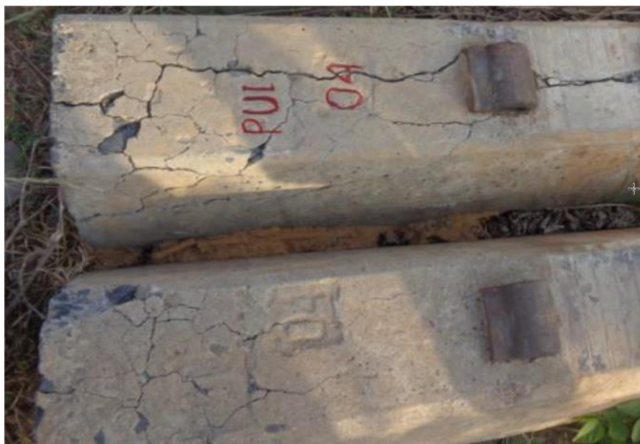
Obr. 4.12: Pražce porušené formacemi ettringitu, (Awasthi, 2017) [23] .
