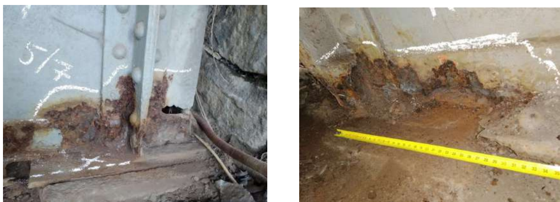
Obrázek 3.7: Degradace nosníků v podporové oblasti
