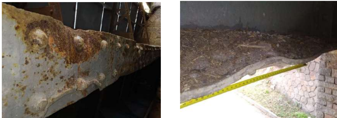
Obrázek 3.6: Degradace nosníků v poli
