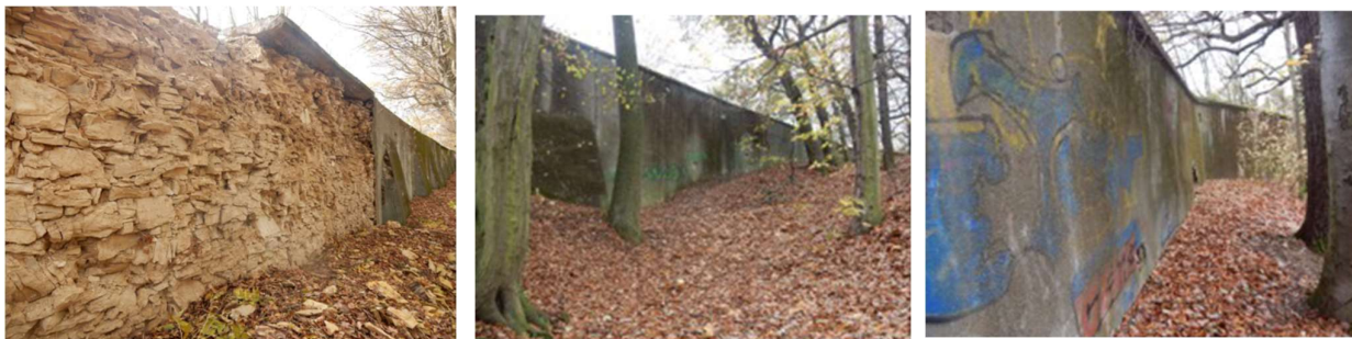
Obr. 6 - 8: Ohradní zeď - původní stav, r. 2017
