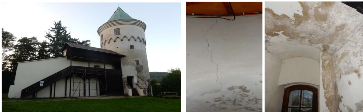
Obr. 24 - 26: Stávající stav hradu s poruchami
