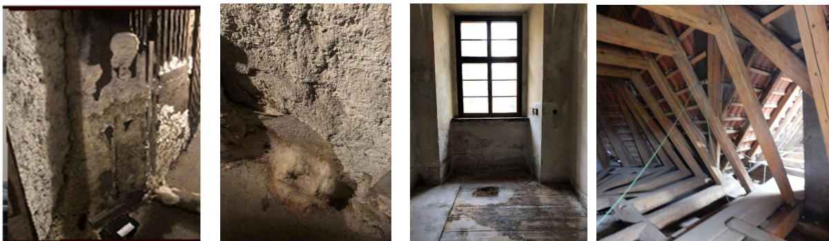
Obr. 82 – 83: Výskyt dřevomorky domácí ve sklepě, Obr. 84: Degradace podlahy, Obr. 85: Krov
