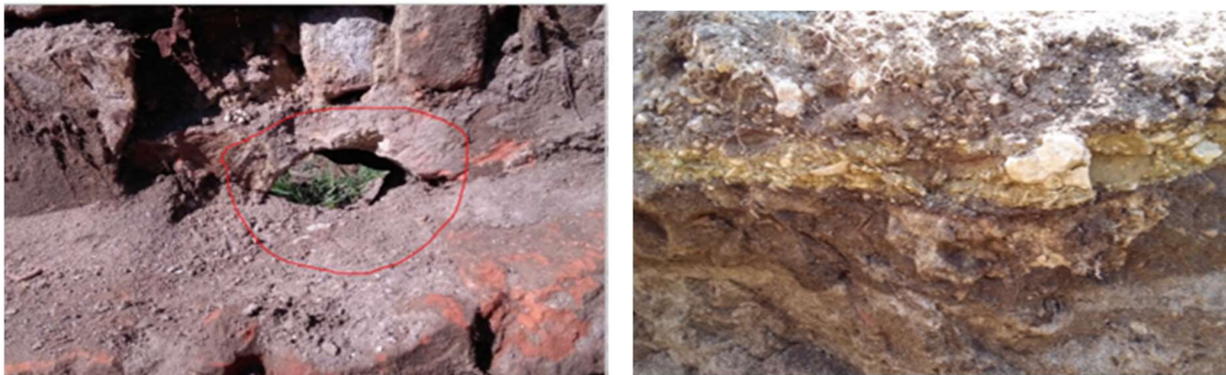
Obr. 56: Nefunkční odvodňovač, Obr. 57: Jílová vrstva
