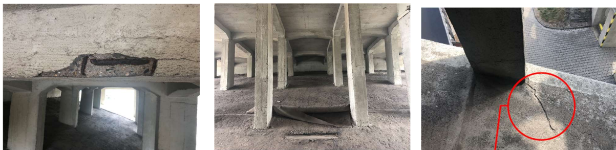
POVRCHOVÁ TRHLINA NA OBLOUKU, OBJ.D
