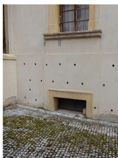
Obr. 86 - 87: Zteřelá asfaltová hydroizolace, Obr. 88 – 90: Poruchy v suterénní části objektu, Obr. 91 - 92: Chybné provedení systému vzduchových kanálků
