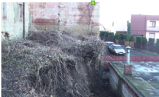
Obr. 198: Zřícení opěrné zdi
