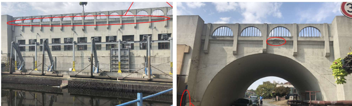
Obr. 153 – 157: Masarykův most - degradace mostního svršku - problematické řešení dilatačních a pracovních spár
