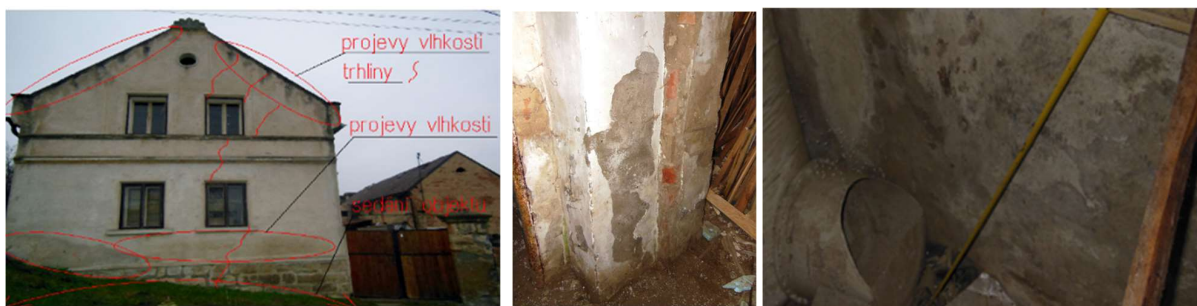
Obr. 195 – 196: Projevy vlhkosti, obj.1, Obr. 197: Projevy vlhkosti, obj.2
