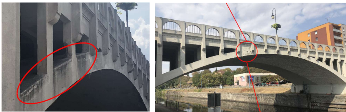
Obr. 148 – 149: Degradace nosné konstrukce Masarykova mostu, objekt D
