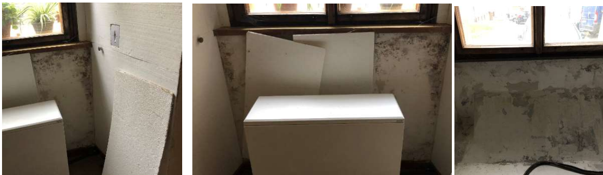
Obr. 79 - 81: Neodborný zásah – provedení vnitřního zateplení u oken
