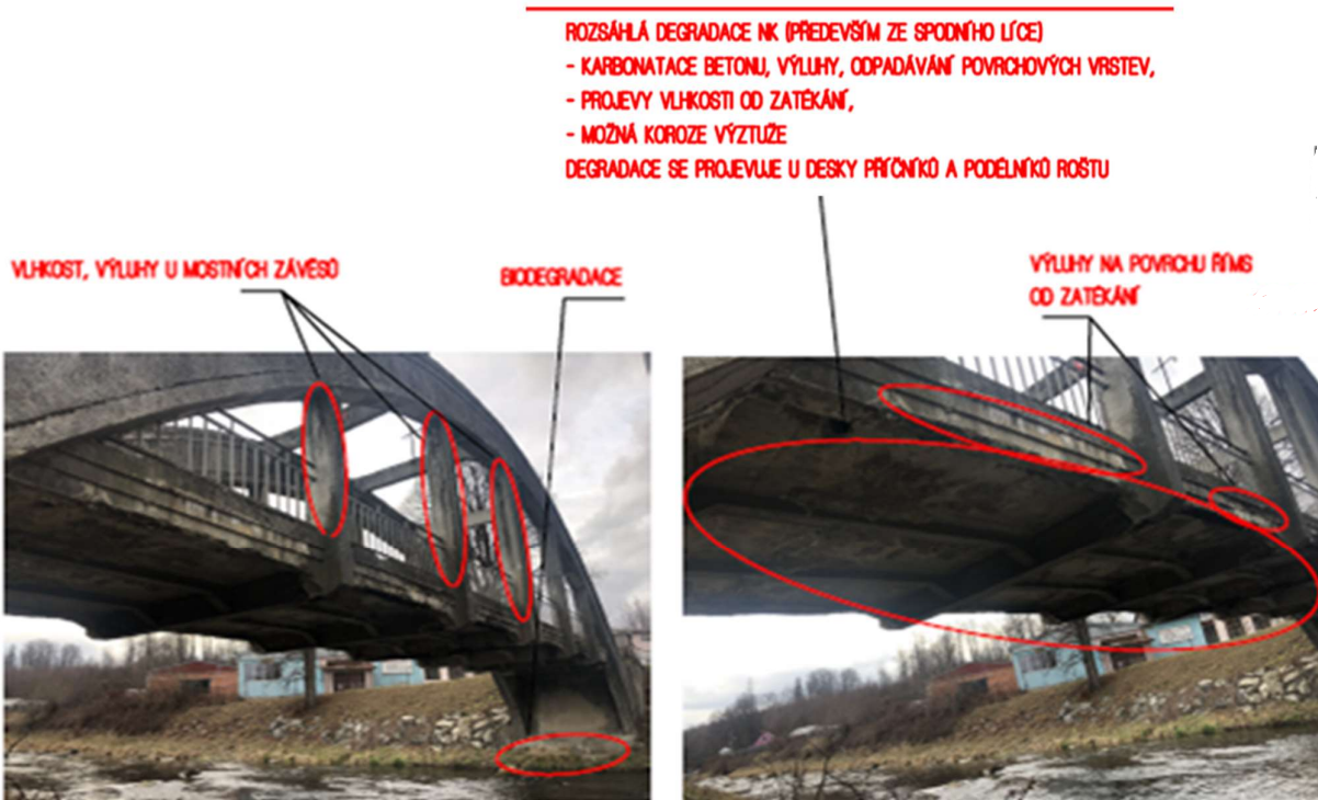
Obr. 170 – 171: Most v Jeseníku - degradace nosných konstrukcí
