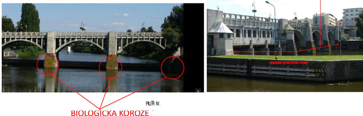
Obr. 146 - 147: Degradace spodní stavby Masarykova mostu, obj. B,C
