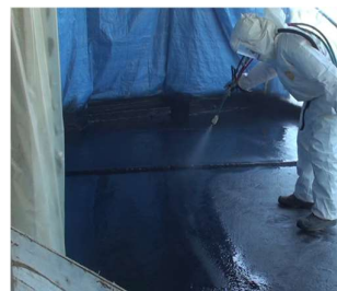
Obr. 200: Původní stav objekt 1 Obr. 201: Historická usedlost Horky nad Jizerou - aplikace elastomerního polyuretanu, objekt 1
