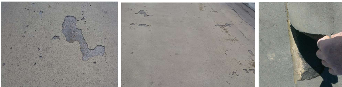
Obr. 180 – 182: Problematická aplikace hydroizolačního materiálu na kaskádách v Praze Tróji, r. 2012
