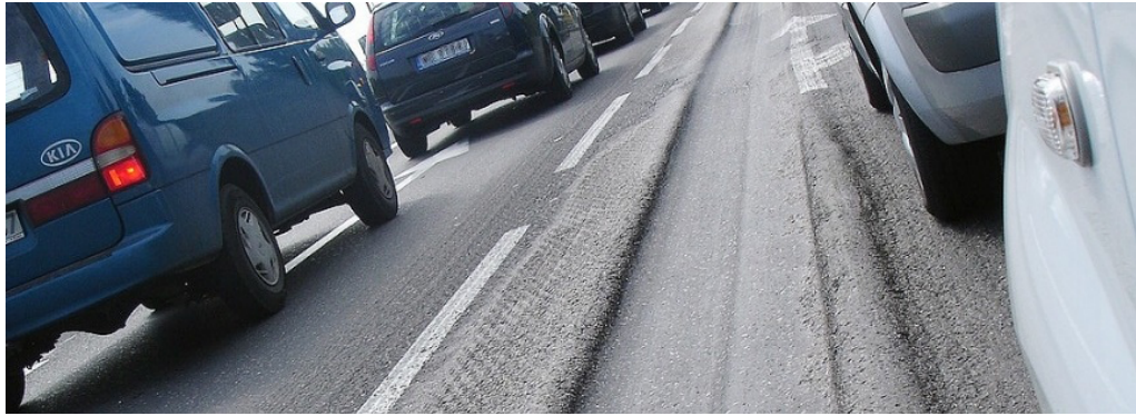
Obrázek 9: Ukázka vyjetých kolejí (trvalé deformace) na pozemní komunikaci [20]
