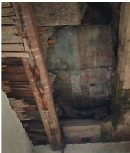
Obrázek číslo 1.21 – Degradace dřevěného trámového stropu nad 1.NP
