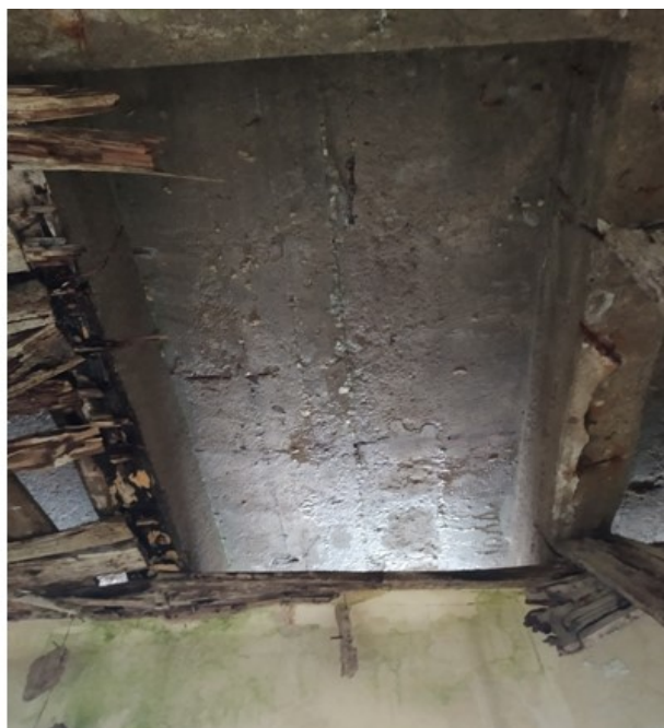
Obrázek číslo 1.67 – Viditelné známky zatékání vody do stropu pod střešním pláštěm
