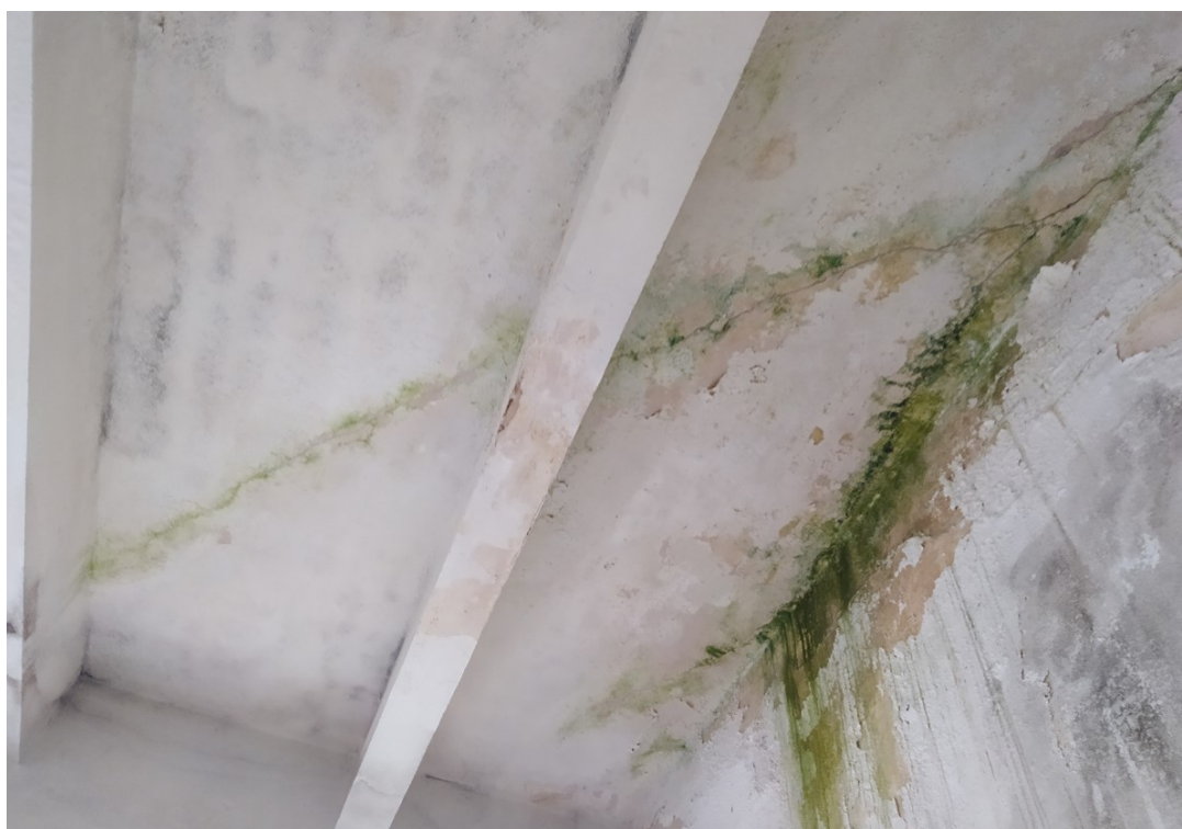
Obrázek číslo 1.59 – Trhlina v omítce na stropní konstrukci TR2
