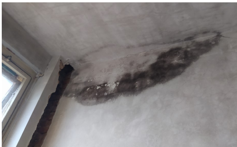
Obrázek číslo 1.52 – Plíseň na stěně
