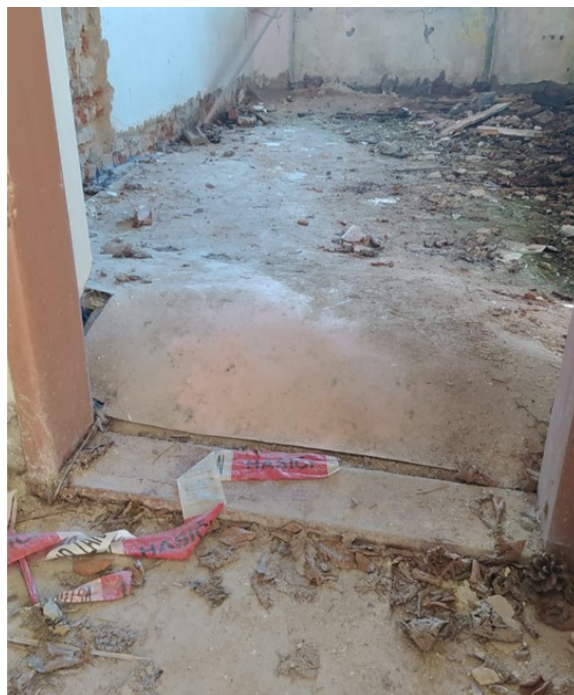
Obrázek číslo 1.65 – „Nafouknutá“ podlaha vlivem vlhkosti v objektu
