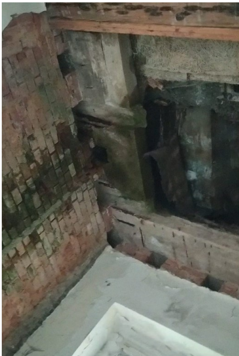
Obrázek číslo 1.57 – Propadlý dřevěný trémový strop ve starší části objektu
