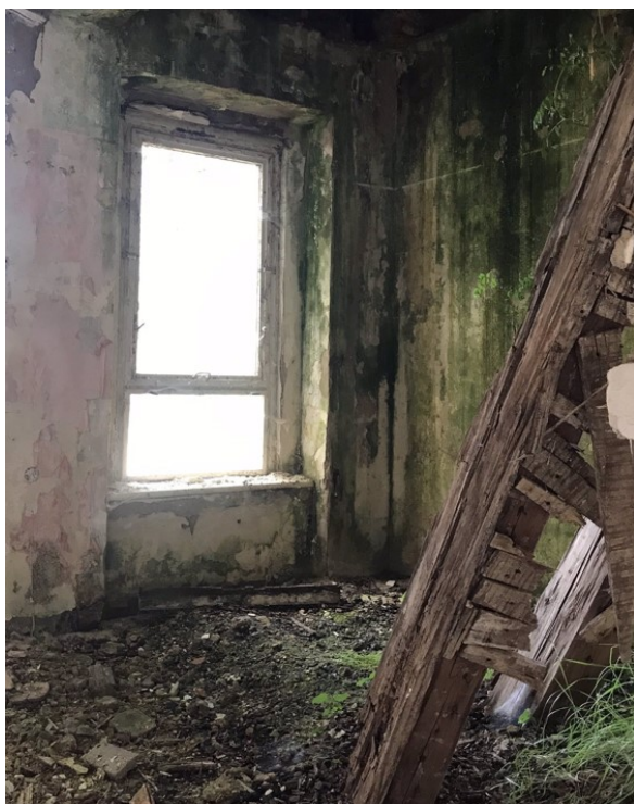
Obrázek číslo 1.55 – Zdivo zasažené vlhkostí
