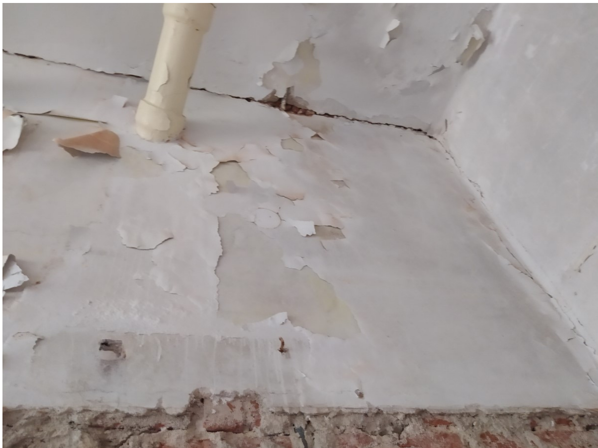
Obrázek číslo 1.60 – Trhlina při styku příčky a stropní konstrukce TR3
