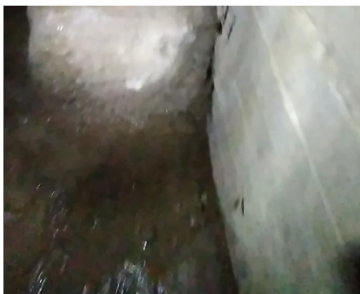
Obrázek číslo 1.70 – Průchozí šachta ve 3. PP během deště
