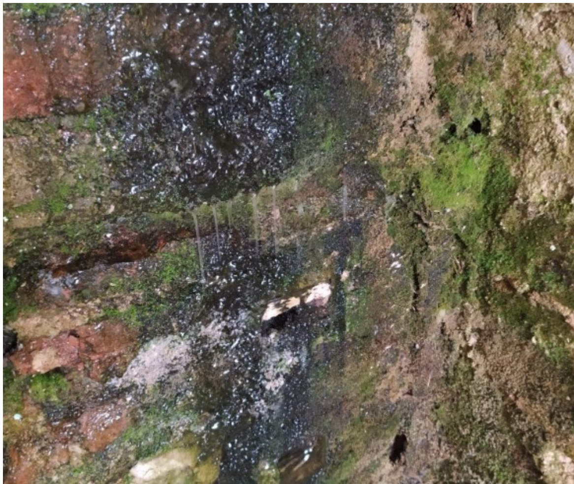
Obrázek číslo 1.68 – Extrémní případ volně stékající srážkové vody po vnitřní stěně ve 4.NP při dešti
