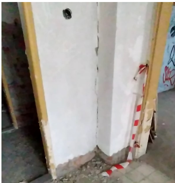
Obrázek číslo 1.54 – Trhlina TR1
