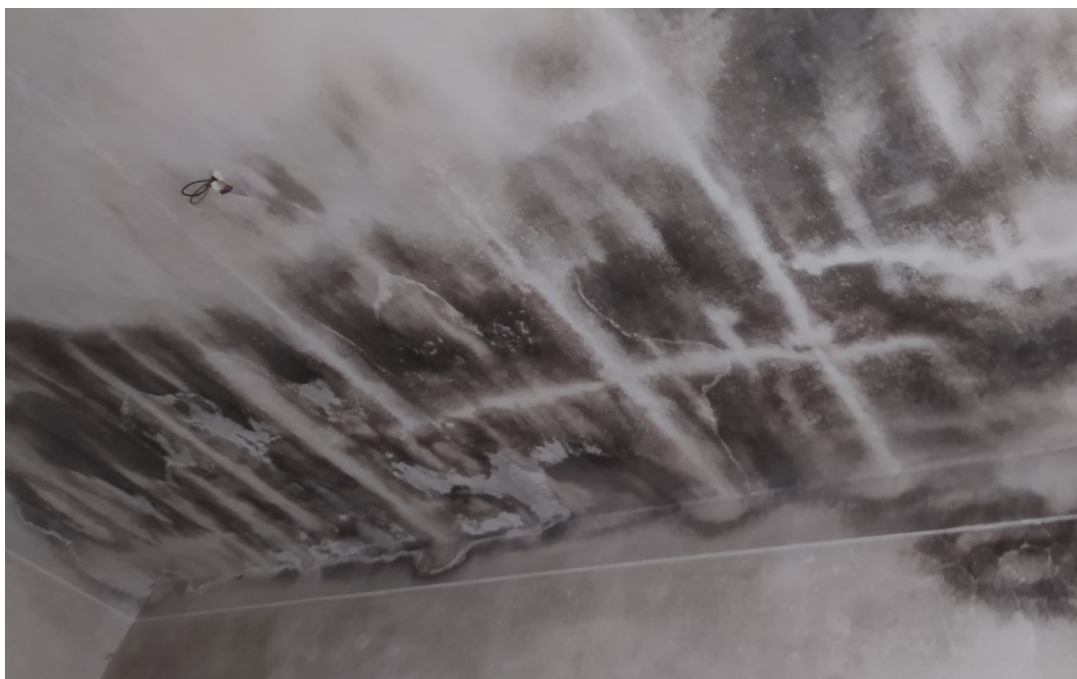
Obrázek číslo 1.58 – Plíseň na omítce stropní konstrukce
