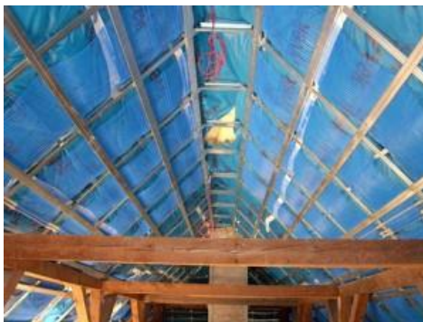
obr. /18/ Instalace kapilárních rohoží v podkroví zámku Tonkovice [20]
