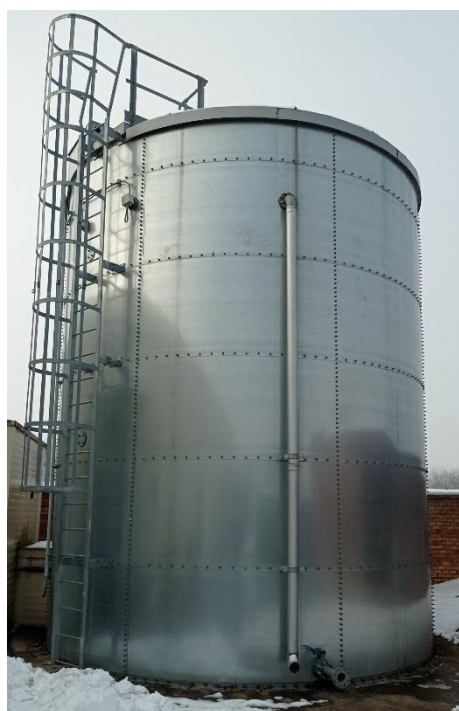
obr. 13: Nadzemní nádrž SHZ [vlastní zdroj fotografie][7]
