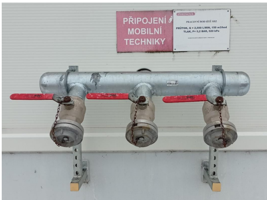
obr. 18: Příklad přípojky pro mobilní techniku HZS na fasádě objektu [vlastní zdroj fotografie]
