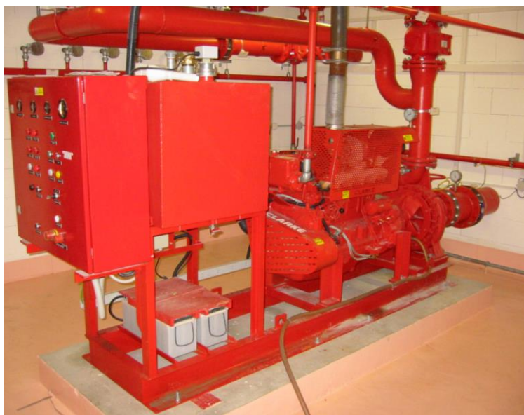
obr. 15: Sprinklerového čerpadlo s dieslovým motorem [6]
