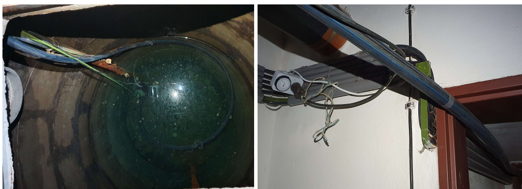
Obr. 25: Čerpadlo ve studni krytu CO (Jakub Řehák)
