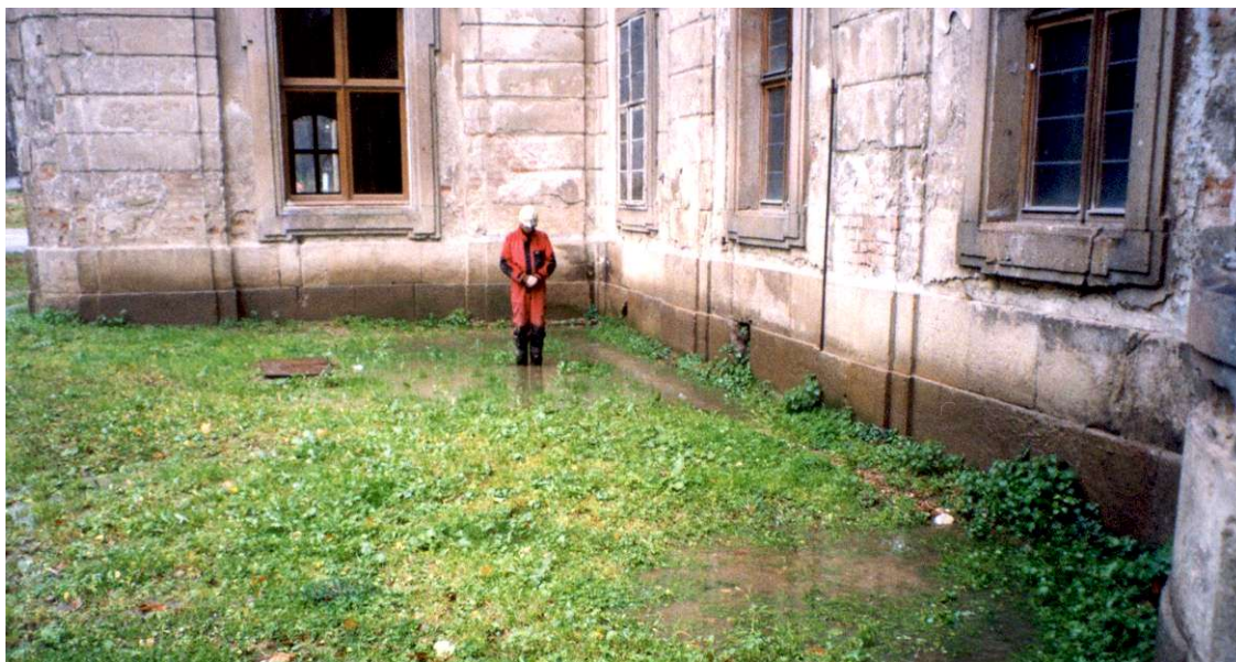
Obr. 20: Stojící voda po dešti u paty objektu před opravou podpovrchových kanálků (archiv SPELEO-Řehák)
