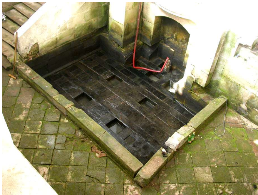
Obr. 13: Odhalený dubový rošt základové konstrukce po vyčerpání vody v severním zrcadle (archiv SPELEO-Řehák)
