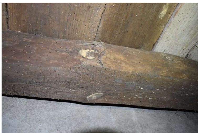
Obr. 37 – Dřevěný trám podírající konstrukci podlahy napadený červotočem
