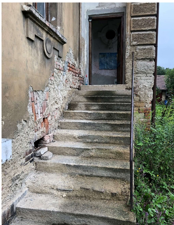
Obr. 41 – Poškození schodiště u vstupu do bytu č. 2
