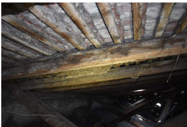
Obr. 47 – Dřevěné prvky napadené hnilobou vlivem zatékání
