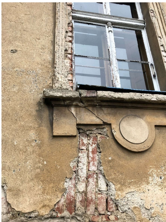
Obr. 53 – Degradace plastického zdobení pod oknem na severní fasádě
