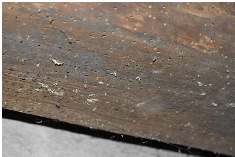
Obr. 85 – Napadení dřevěného trámu provizorní konstrukce podlahy červotočem
