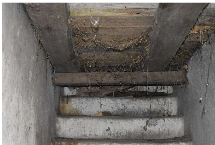
Obr. 36 – Poškození dřevěných trámů v prostoru schodiště ve sklepě
