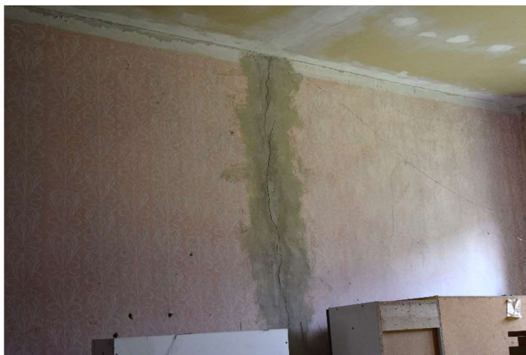
Obr. 32 – Pohled na trhlinu v obývacím pokoji bytu č. 2
