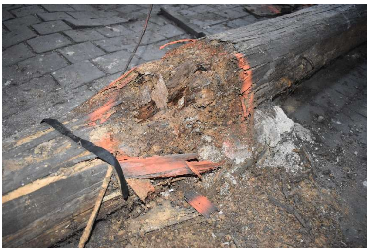
Obr. 42 – Prohnilá část vazného trámu v místě středové podpory
