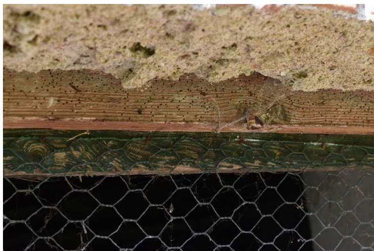
Obr. 51 – Napadení dřevěného rámu okna suterénu dřevokazným hmyzem
