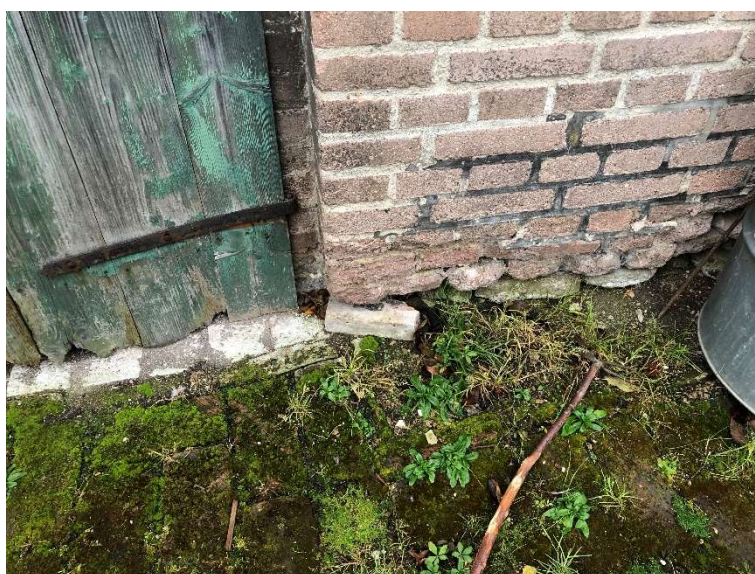
Obr. 56 – Absence drenáže v soklové části objektu
