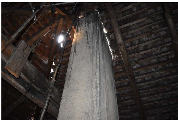
Obr. 35 – Zatékání střešní konstrukcí vlivem absence oplechování komína
