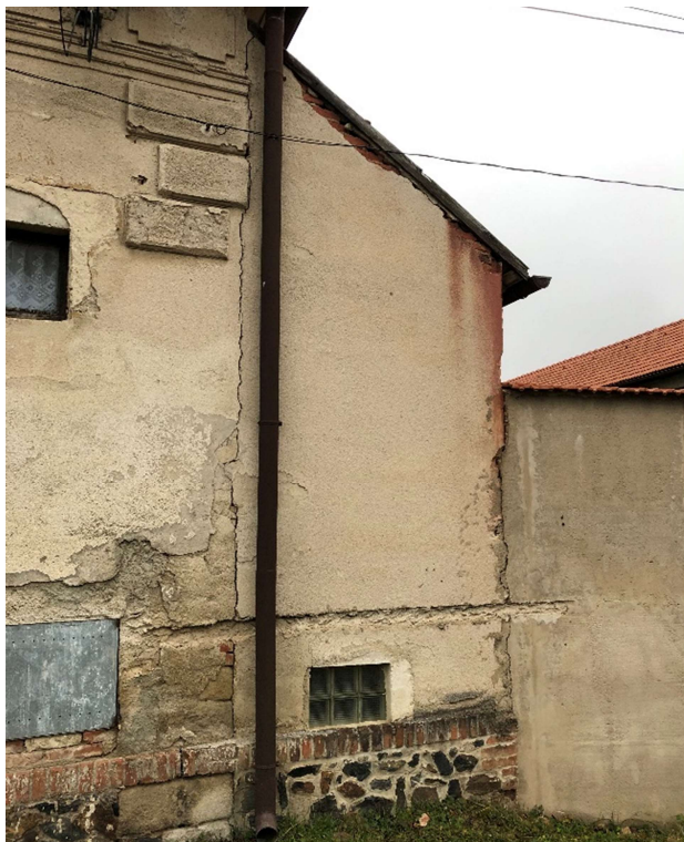
Obr. 34 – Trhlina kopírující linii napojení jižního přístavku na hlavní objekt
