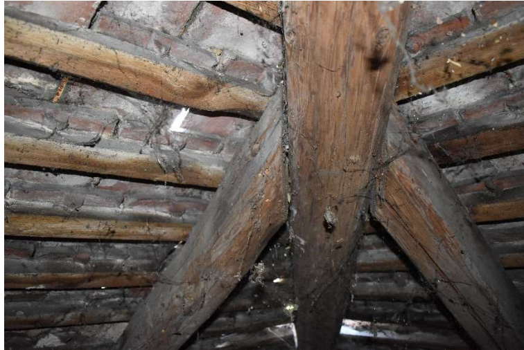
Obr. 48 – Rozevirání tesařského spoje v místě napojení krokvi
