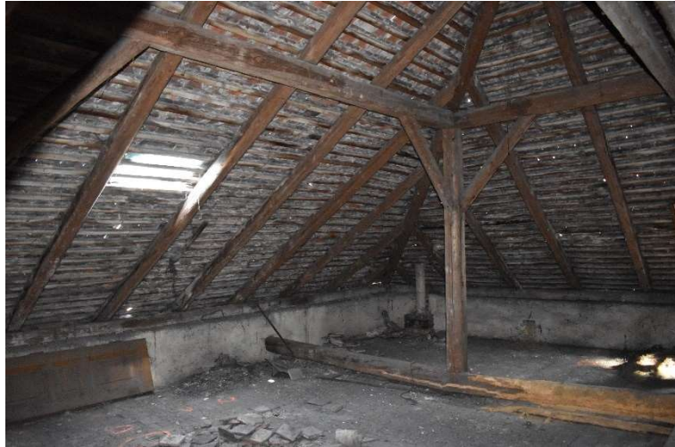
Obr. 23 – Valba hlavní části krovu na severní straně budovy
