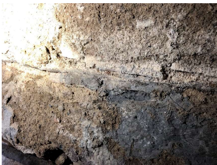
Obr. 65 – Obnažená vrstva jílové hydroizolace ve sklepě v místnosti č. 010
