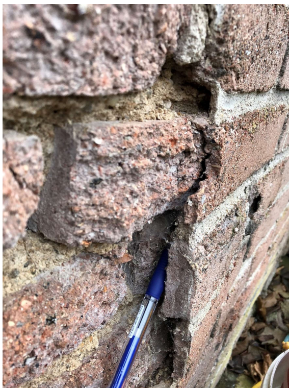
Obr. 55 – Degradace cihelného zdiva schodiškové stěny u severního přístavku
