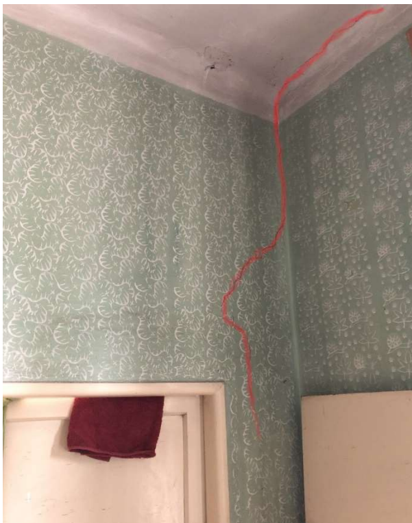
Obr. 31 – Pohled na trhlínu (červeně zvýrazněna) v dětském pokoji v bytě č. 2
