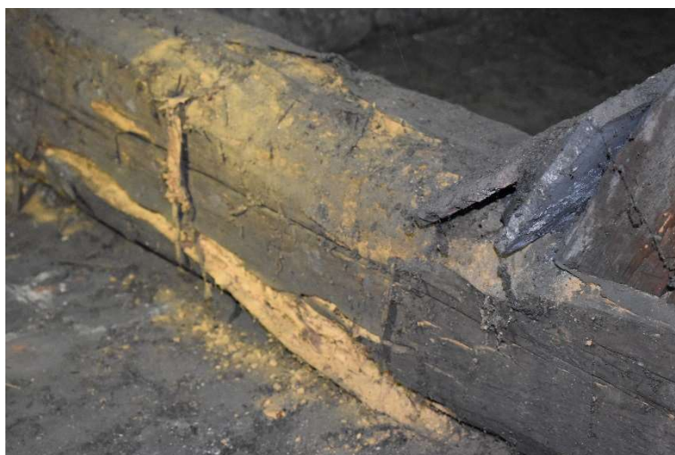
Obr. 88 – Napadení vazného trámu dřevokaznými činiteli
