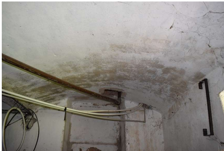
Obr. 59 – Vlhkostní mapy na klenbě ve sklepním prostoru
