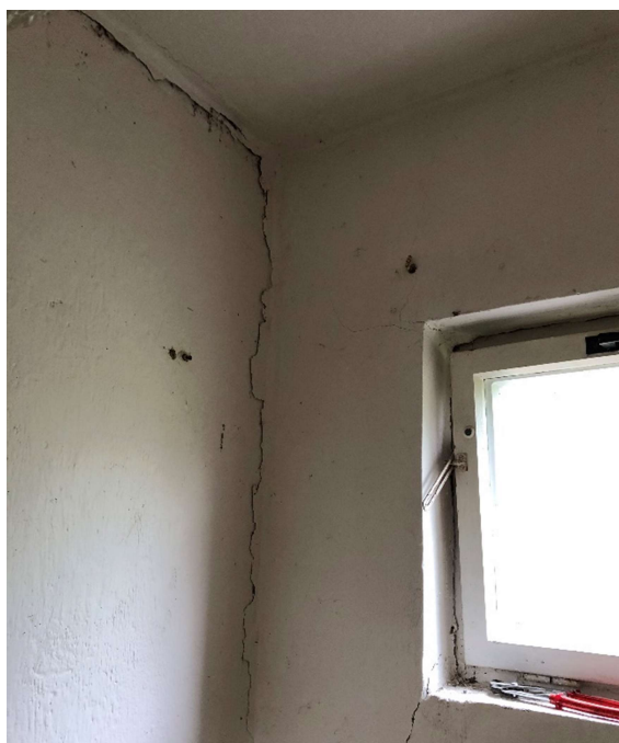
Obr. 33 – Poškození stěn trhlinami v koupelně bytu č. 3
