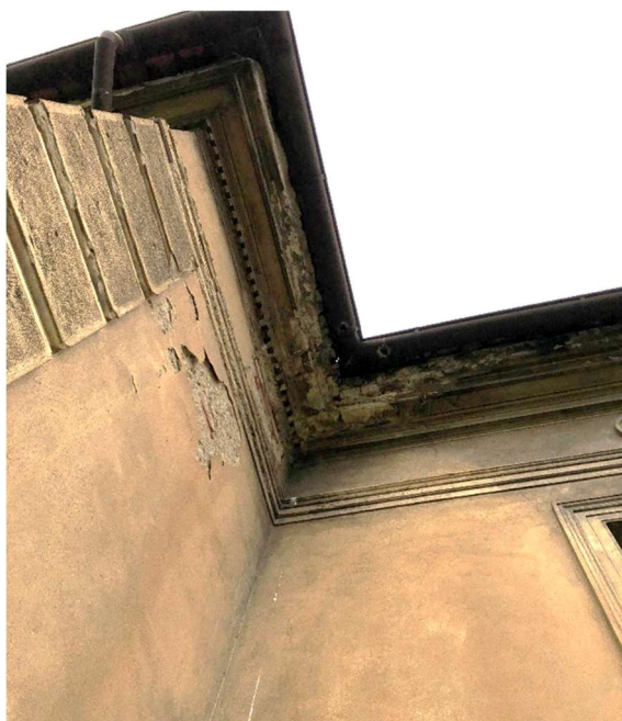
Obr. 57 – Poškozený okapový žlab v místě úžlabí střechy
