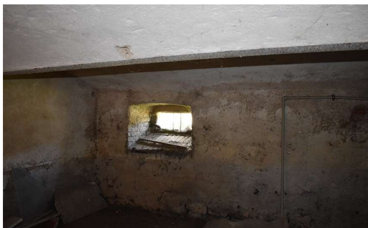
Obr. 39 – Ocelové nosníky podléhající korozi vlivem zatékání střešní konstrukcí a vlhkosti vzduchu
