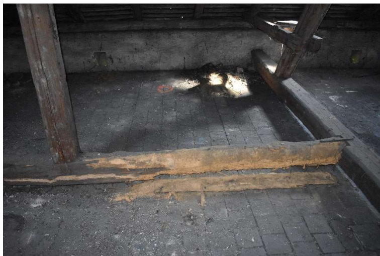
Obr. 45 – Odpadávání povrchových vrstev průřezu vazného trámu
