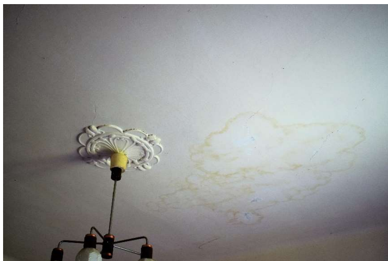
Obr. 40 – Poškozená omítka v ložnici bytu č. 3 vlivem zatékání střešním pláštěm
