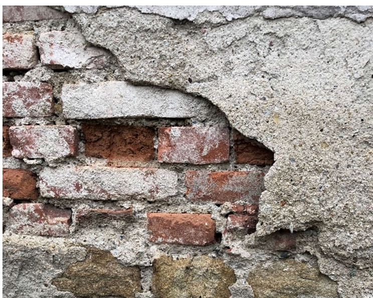
Obr. 30 – Degradace obvodové konstrukce vlivem zvýšené vlhkosti
