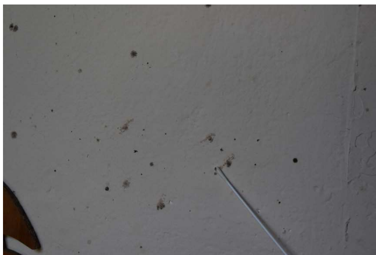
Obr. 71 – Použití stěrové metody pro přenos plísně do laboratorního prostředí
