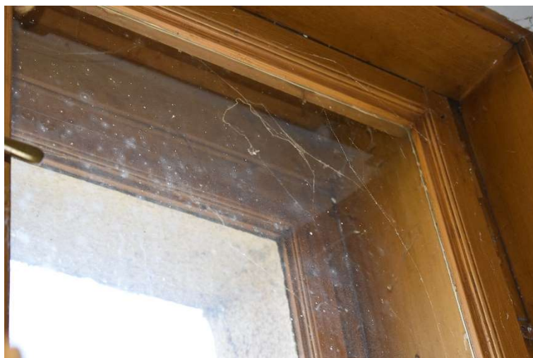
Obr. 52 – Známky výskytu plísní na skleněné výplni okenního otvoru
