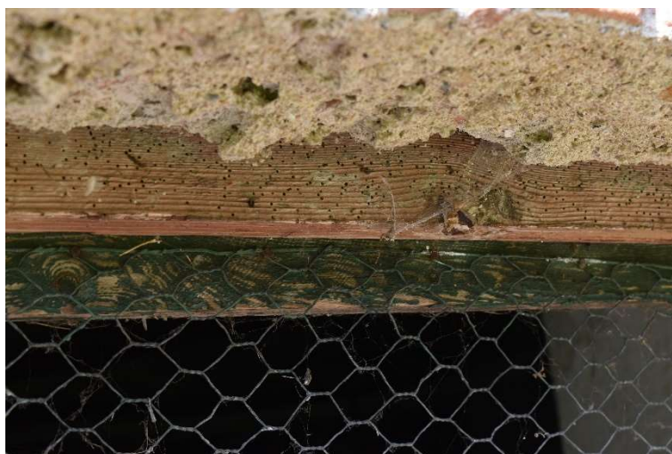
Obr. 86 – Napadení dřevěného rámu okna suterénu červotočem
