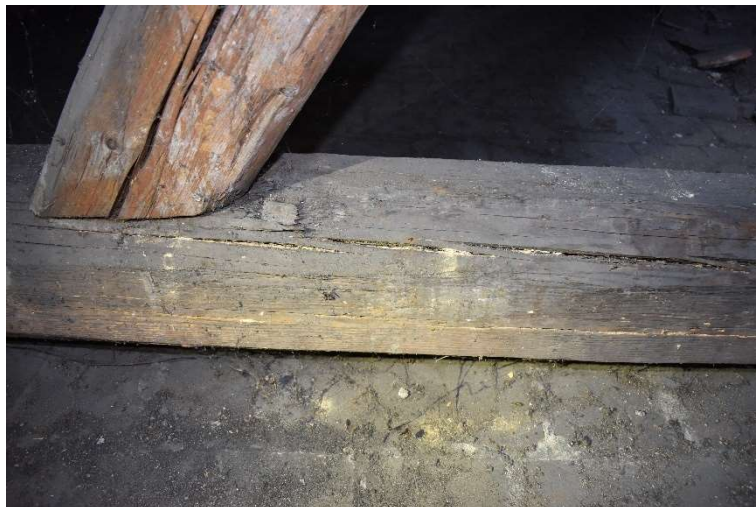
Obr. 49 – Výsušné trhliny v šikmém sloupku a vazném trámu
