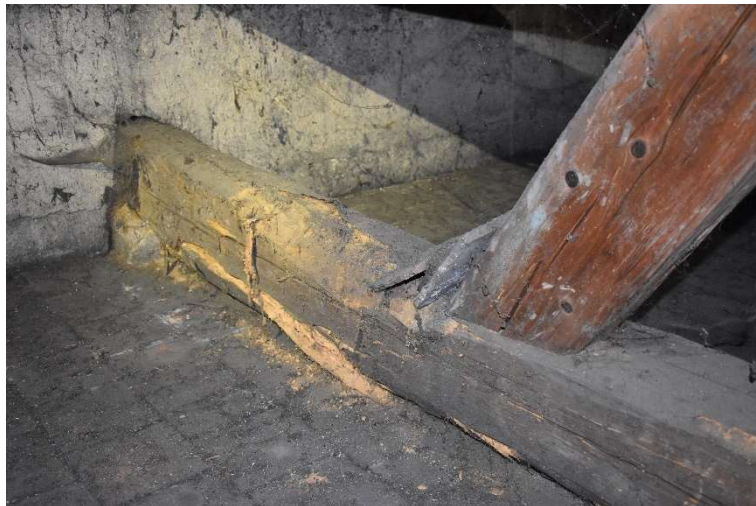
Obr. 44 – Poškození vazného trámu v místě začepování šikmého sloupku vlivem zatékání a působení dřevokazného hmyzu
