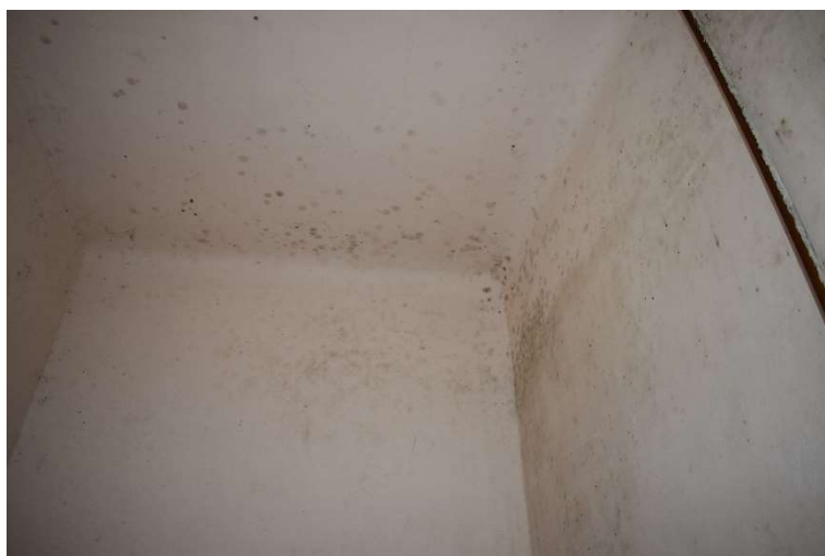
Obr. 60 – Výskyt plísní v rohu místnosti (v místě tepelného mostu)
