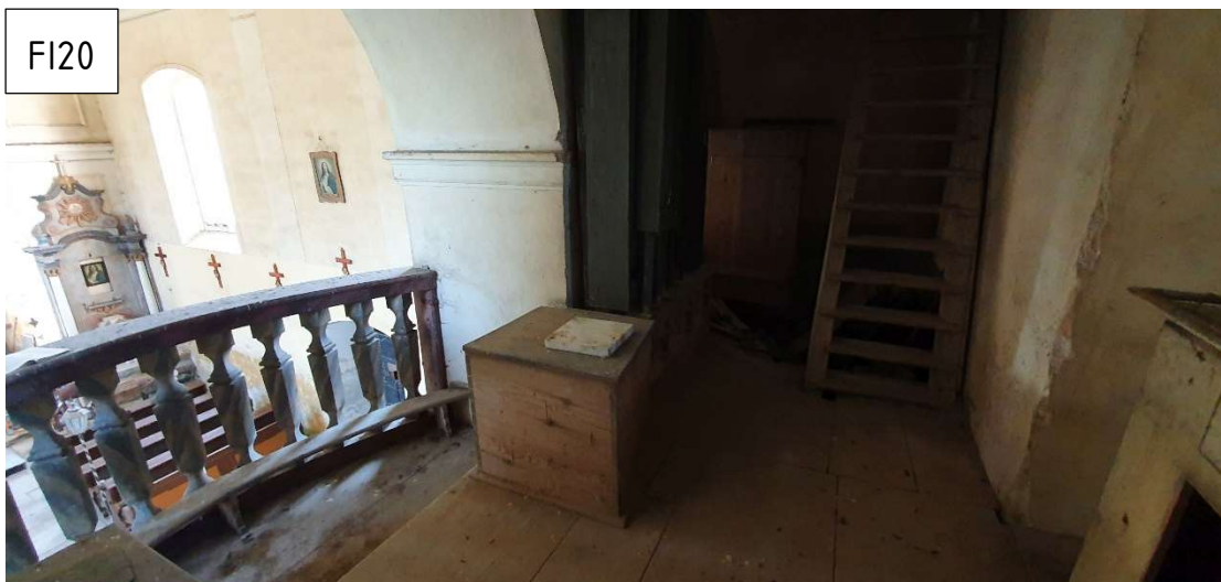
F.39 - Pohled na zničené varhany a vstup do krovu
