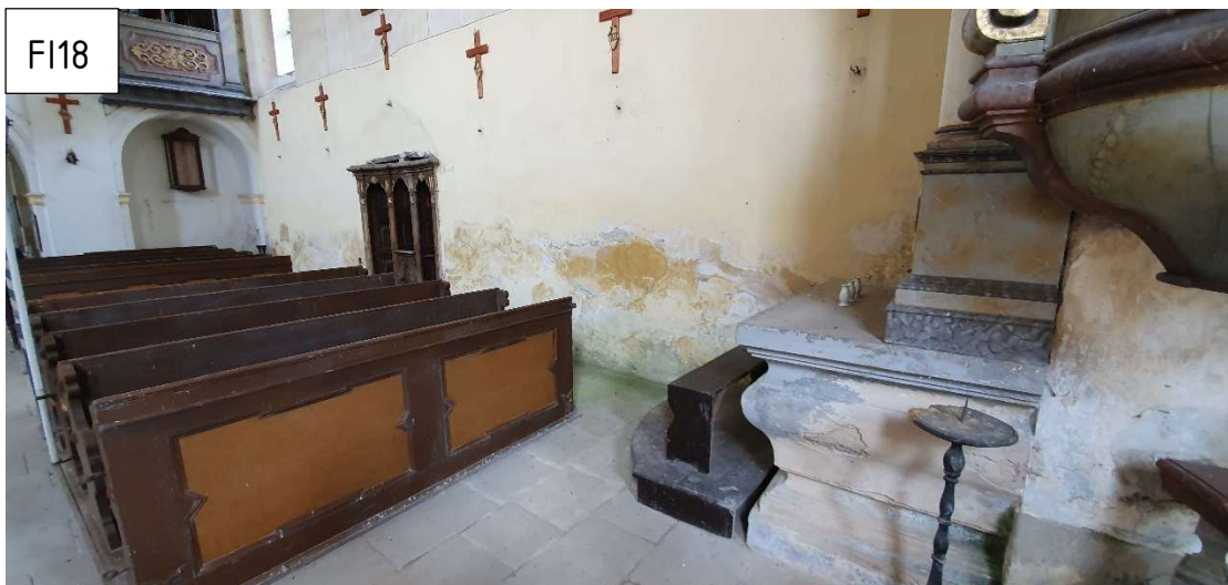
F.37 - Pohled na levou zeď hlavní lodi (viditelné vlhkostní mapy)
