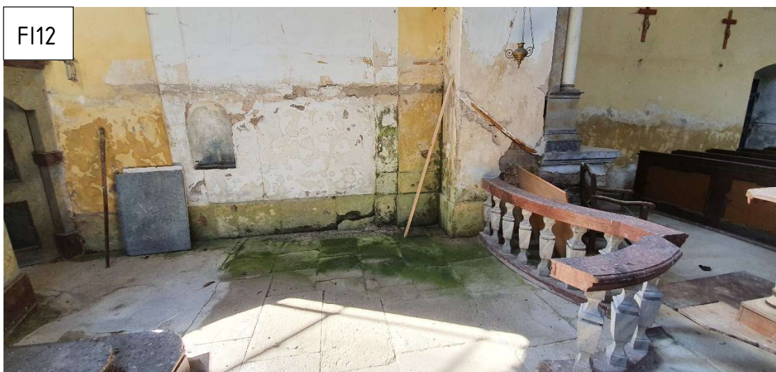
F.31 - Degradace podlahy v části presbytáře, u pravého hlavními pilíře
