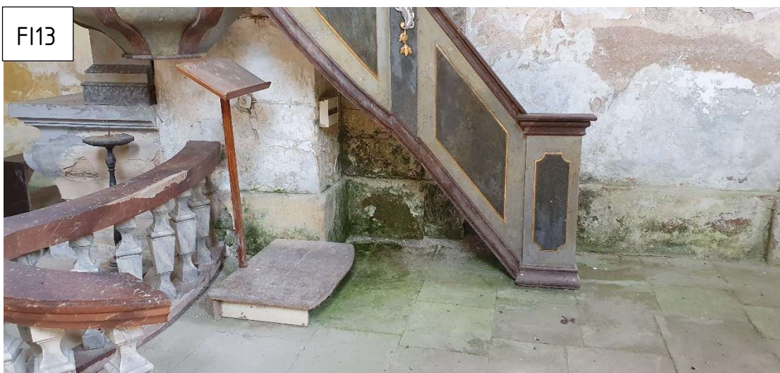
F.32 - Degradace podlahy v části presbytáře, u levého hlavními pilíře
