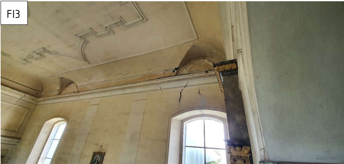
F.22 - Vnitřní pohled na pravou podélnou stěnu, trhliny v okně
