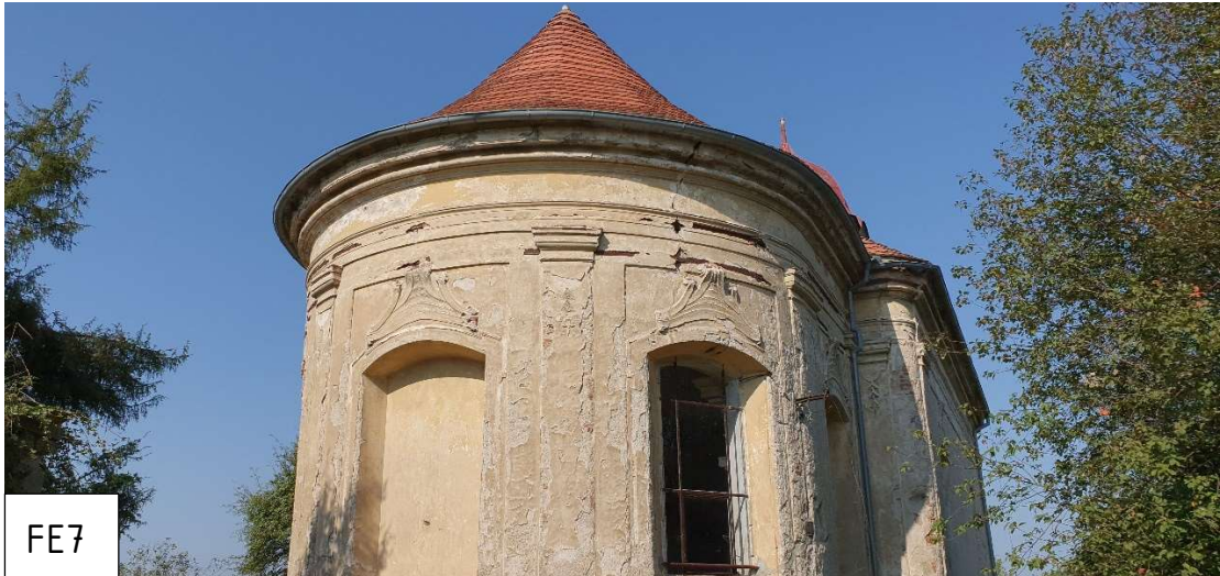
F.7 - Pohled na vnější část presbytáře, viditelné ocelové opásání
