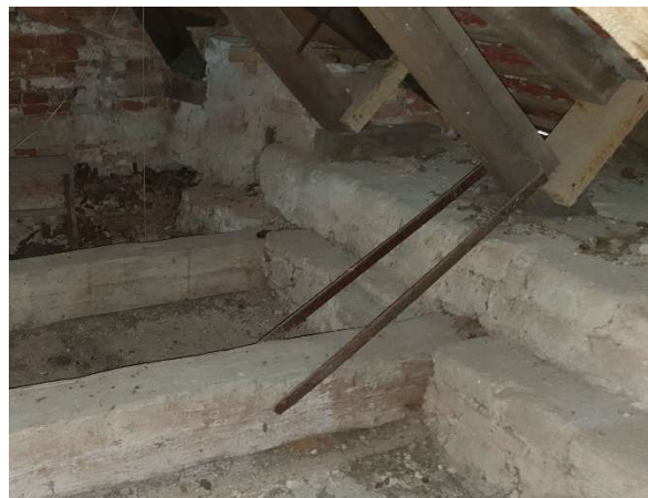
Obrázek 141 - Zachytávání vodorovné síly z krovu (degradace zhlaví VT) - vlastní foto
