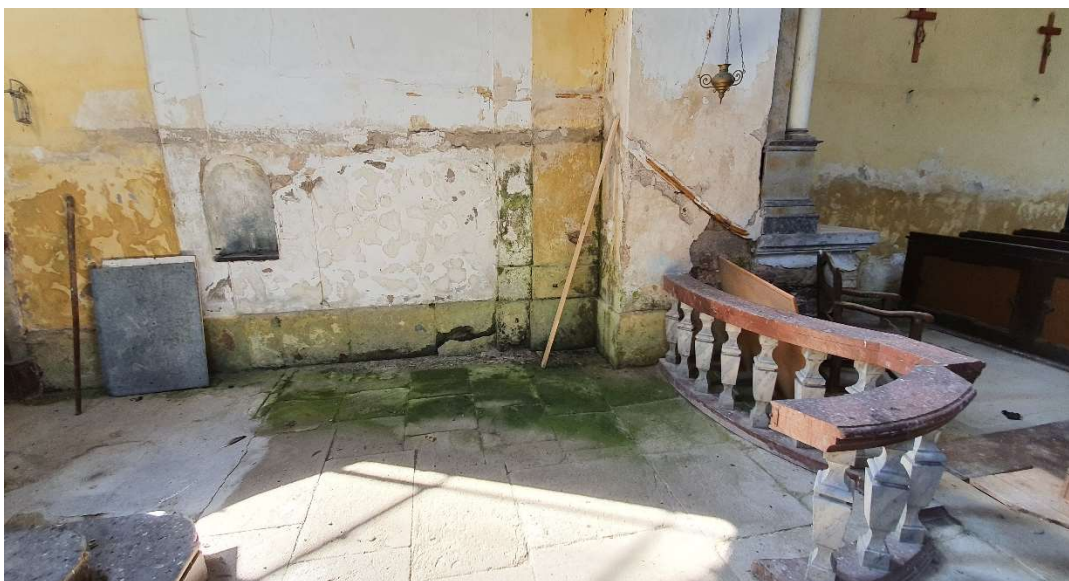
Obrázek 54 - Degradace paty hlavního pilíře - vlastní foto
