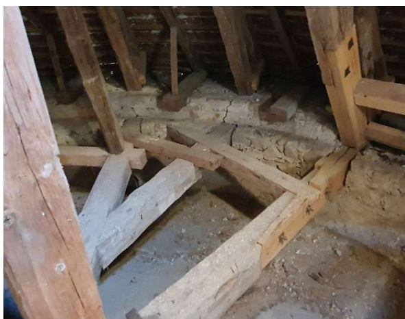
Obrázek 87 - Trhliny nadezdívce pokračující do stěny - pohled z krovu - vlastní foto
