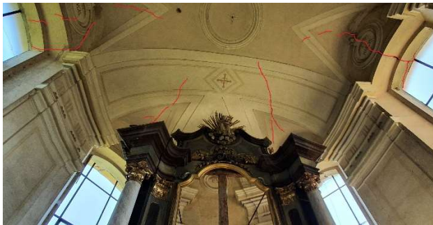
Obrázek 68 - Trhliny u lunet - vlastní foto
