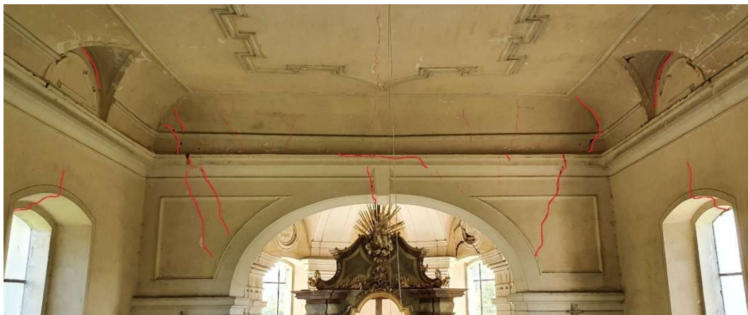
Obrázek 62 - Trhliny ve vítězném oblouku - vlastní foto
