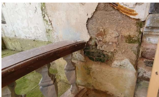
Obrázek 52 - Zdegradovaná pata pilíře a podlaha - vlastní foto
