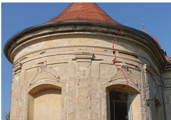
Obrázek 70 - Vnější trhlina v půlkruhovém kněžišti - vlastní foto
