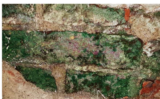
Obrázek 53 - Detail degradace CPP - vlastní foto
