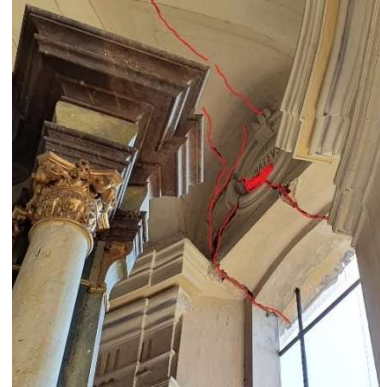
Obrázek 69 - Utržený překlád a trhliny v lunetě - v.f.
