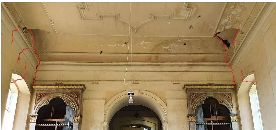
Obrázek 55 - Trhliny mezi podélnou a příčnou částí - vlastní foto
