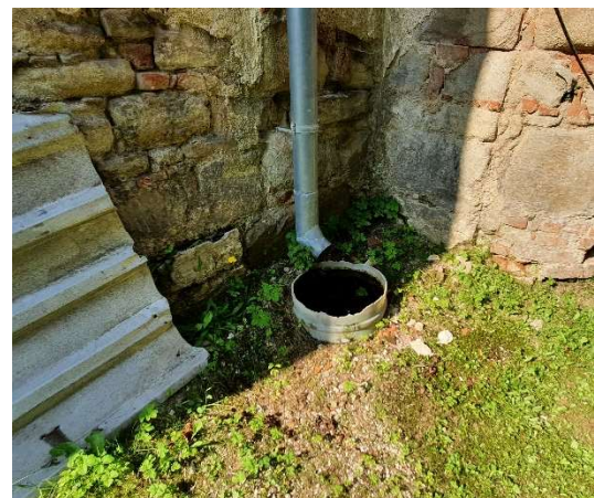
Obrázek 61 - Neprovedené odvodnění u pilířů - vlastní foto
