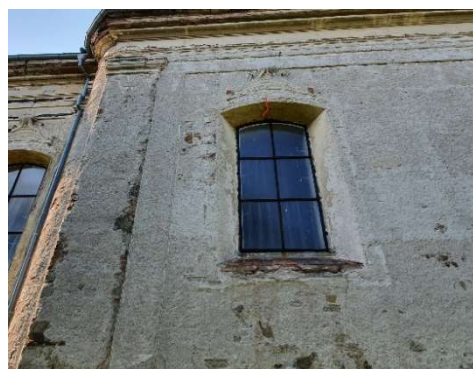
Obrázek 64 - Trhlina nad levým oknem při vstupu do kněžiště - vlastní foto
