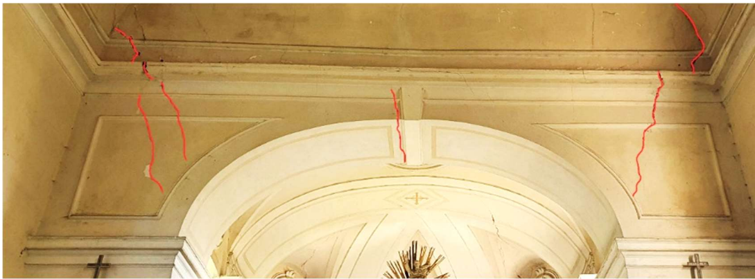
Obrázek 154 - Pohled na trhliny ve vítězném oblouku - vlastní foto
