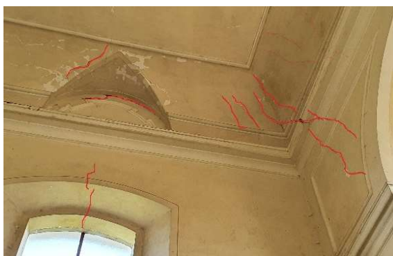
Obrázek 63 - Trhliny nad levým oknem při vstupu do kněžiště - vlastní foto
