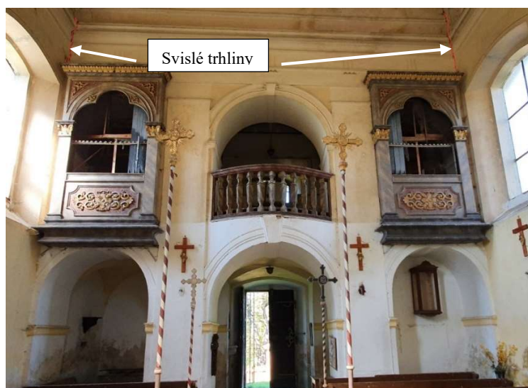
Obrázek 139 - Analyzované trhliny - část tribuny - vlastní foto
