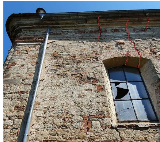
Obrázek 59 - Trhliny nad pravým oknem při vstupu - vlastní foto
