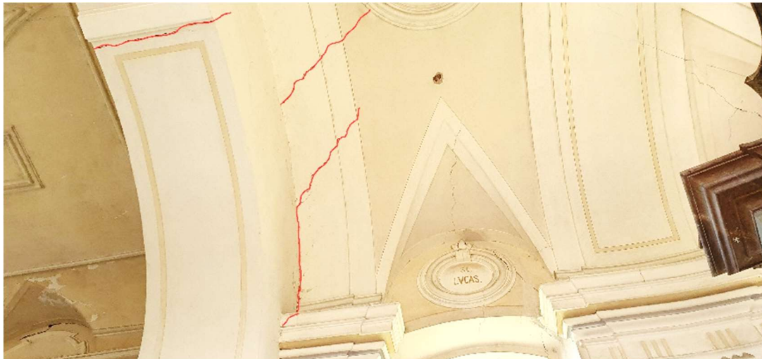
Obrázek 155 - Pohled na trhliny na styku oblouk - valená klenba - vlastní foto
