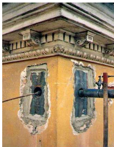
Obrázek 186 - Spínání kabely MONOSTRAND - kostel sv. Petra a Pavla v Horních Dubňanech - viditelné roznášecí desky a oblast kotvení [37]
