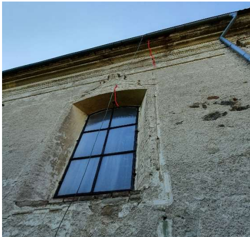
Obrázek 58 - Trhliny nad levým oknem při vstupu - vlastní foto
