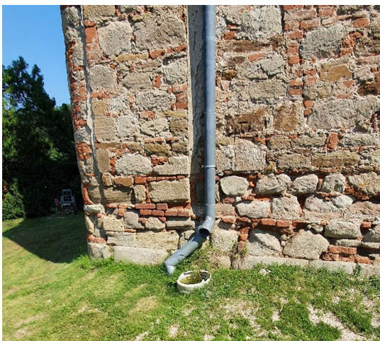
Obrázek 60 - Odtokový svod - možná příčina problému - vlastní foto
