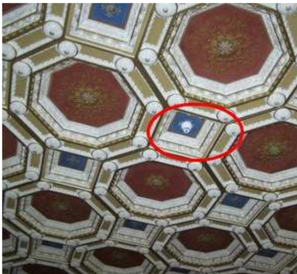
Obr. 9: Bílý bodový hlásič na stropě [14]
