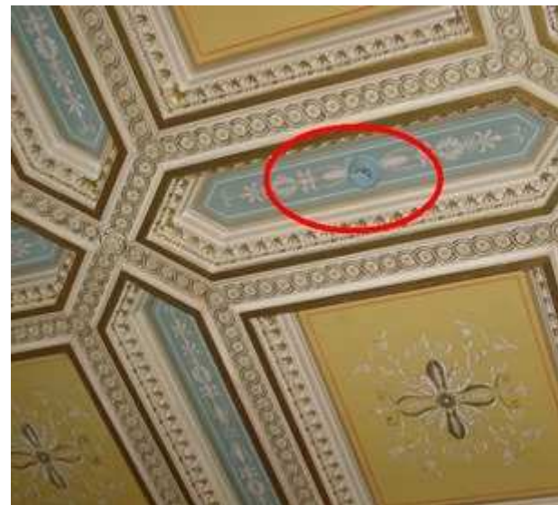
Obr. 10: Bodový hlásič na stropě v barevném provedení [14]
