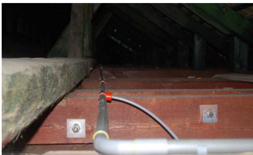
Obr. 12: Vzorkovací potrubí vedené na půdě objektu [11]
