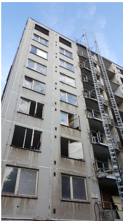
OBRÁZEK Č. 16 – STÁVAJÍCÍ VÝPLNĚ OTVORŮ
