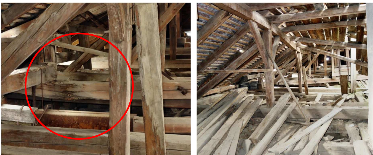
Obr. 32 (vlevo) – Krov – pohled k západu na prasklý vazný trám [5]
