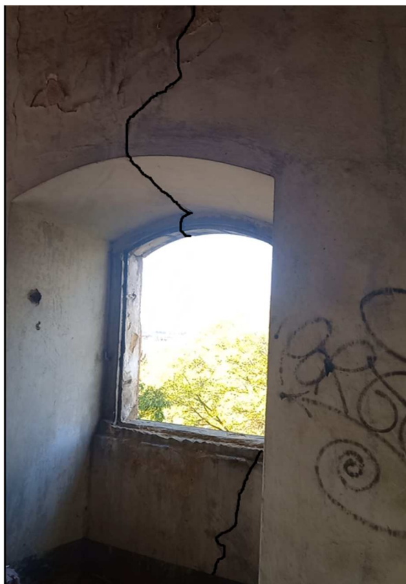
Obr. – 3.33 Trhlina CV4.8 z interiéru
