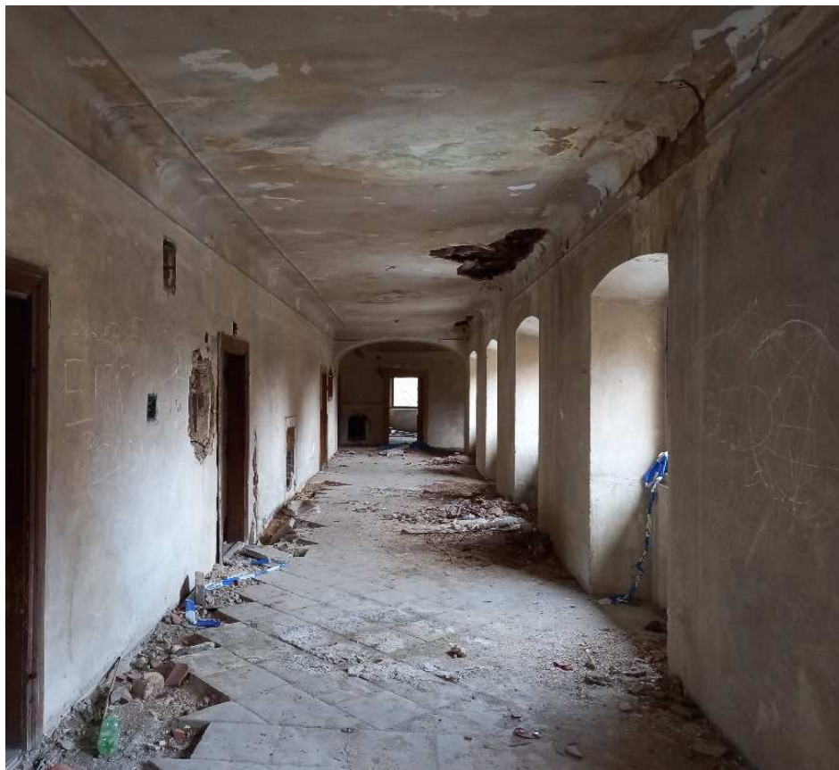
Obr. 3.59 – Chybějící dlaždice, vznikající plíseň na podlaze pod vlhkým stropem
