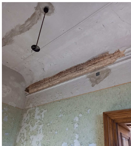
Obr. 3.58 – Odlupování omítky a odhalená falešná klenba
