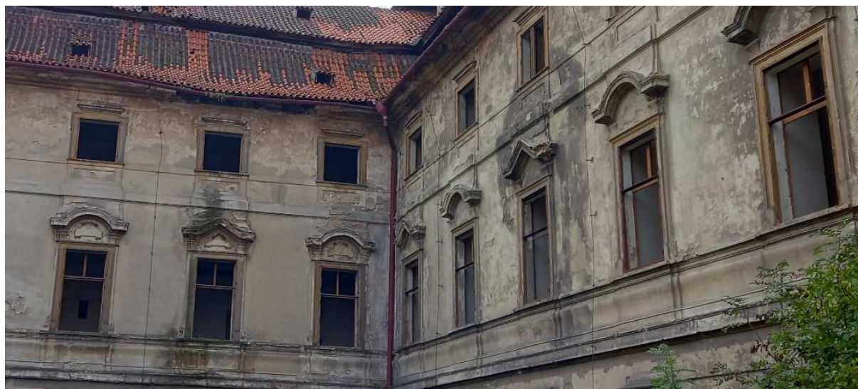
Obr. 3.70 – Degradované římsy a vlhkostní mapy
