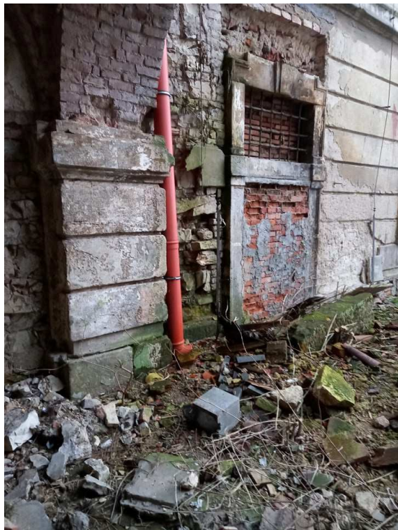
Obr. 3.60 – Zeleň a degradace zdiva
