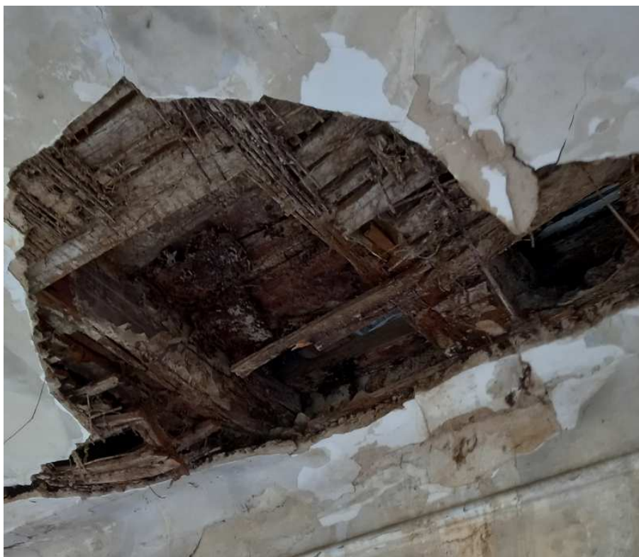
Obr. 3.52 – Prohnilé vazné trámy
