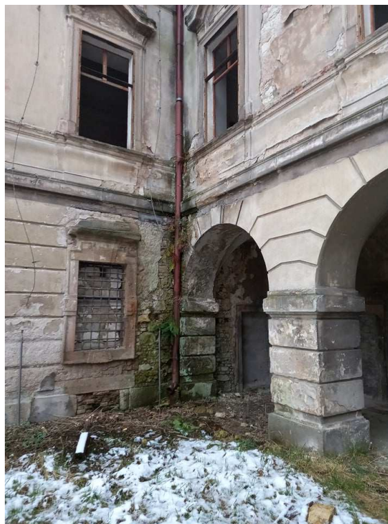
Obr. 3.61 – Zeleň a degradace fasády
