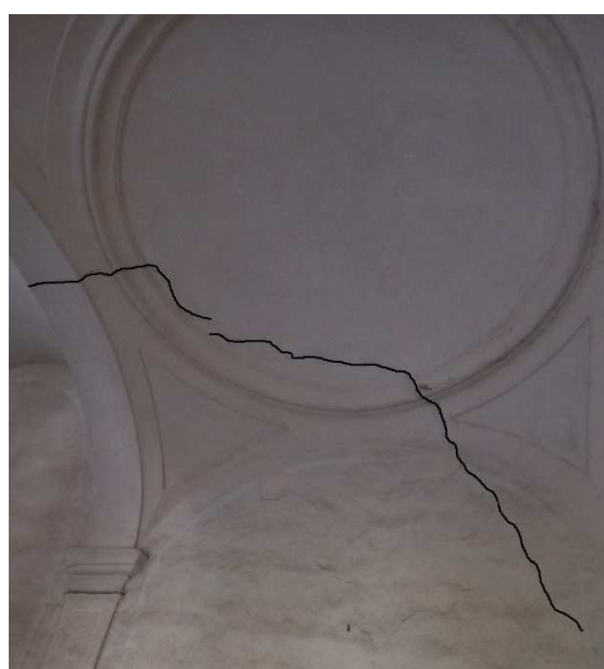
Obr. 3.51 – Trhlina v české placce
