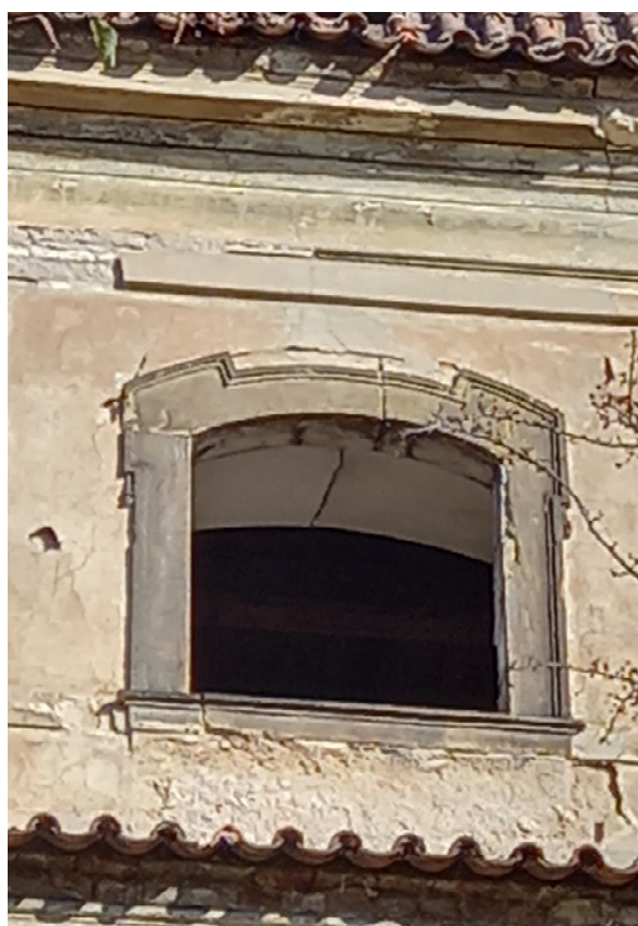
Obr. 3.34 – Trhlina CV4.8 z exteriéru
