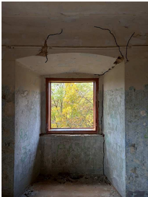
Obr. 3.37 – Trhlina CV3.9 z interiéru
