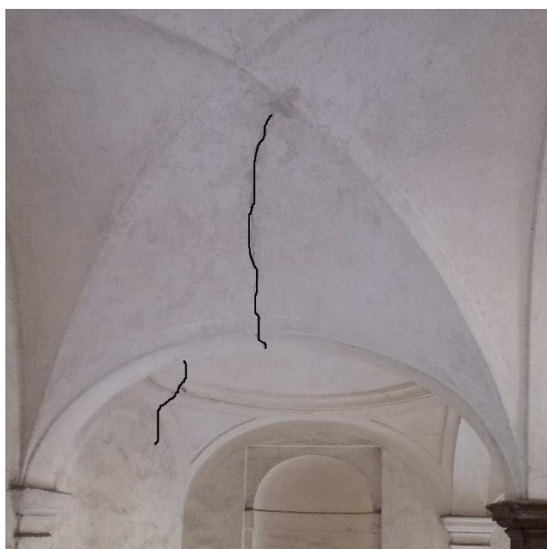
Obr. 3.50 – Trhlina v křížové klenbě
