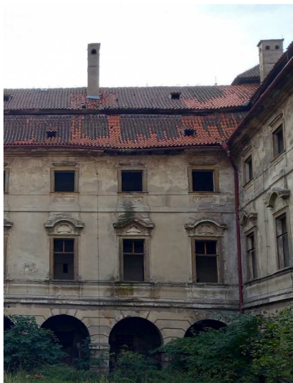
Obr. 3.47 – Pokles střechy nad zborcenou římsou
