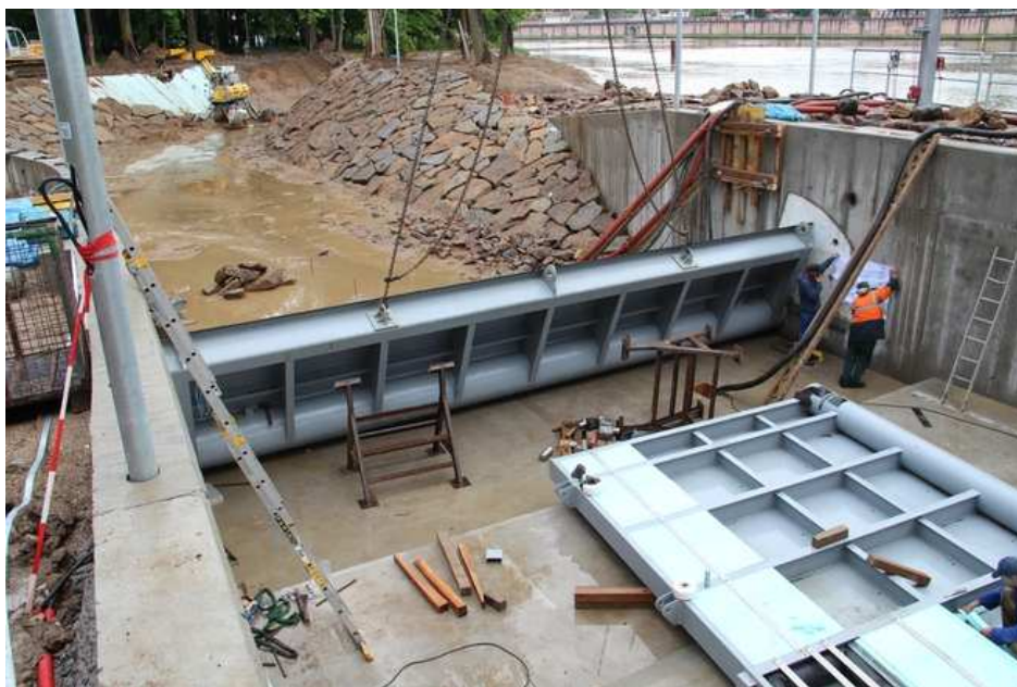
Obrázek 9: Instalace přezdné klapky na vstupní části USD v Roudnici nad Labem. (dostupné z: https://www.padler.cz/stary-novy-kanal-v-roudnici-nad-labem/ )
