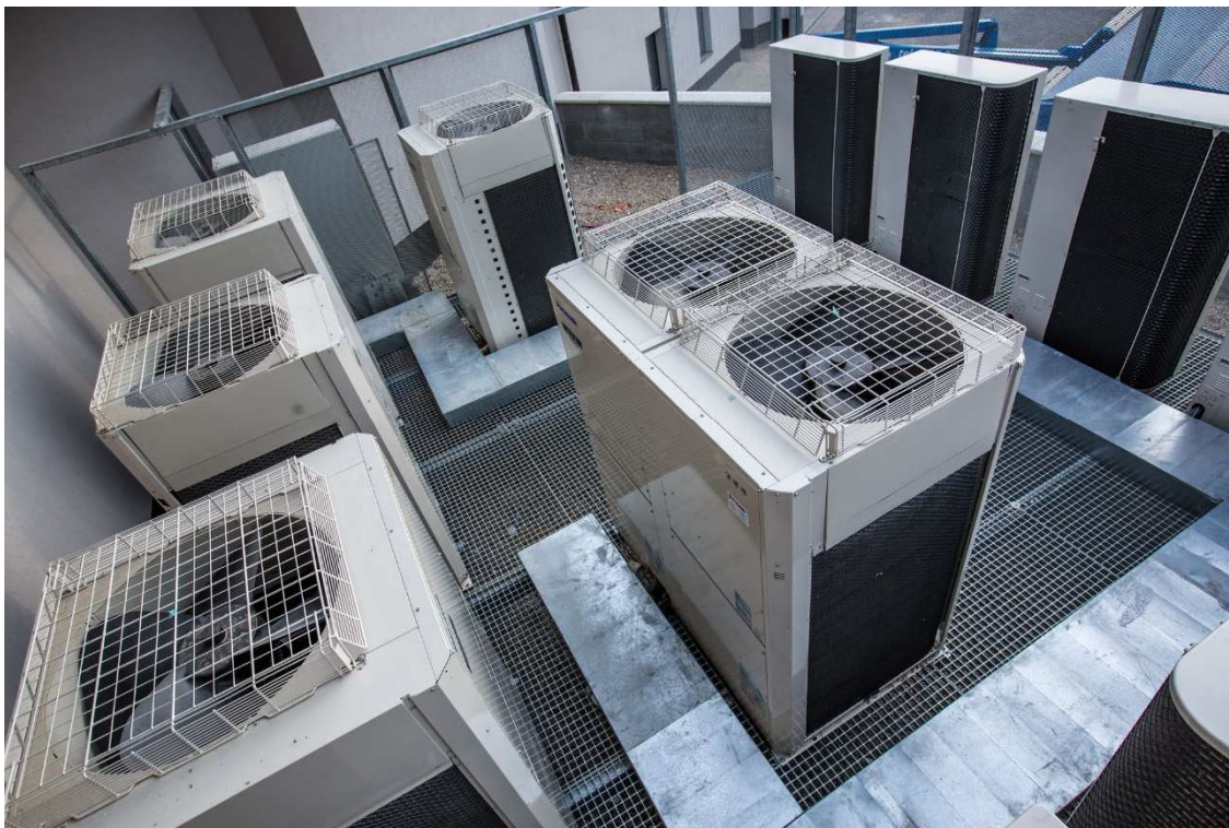
Obr. 7 Venkovní kondenzační jednotky VRF systémů, Victory Casino Brno [3.9]
