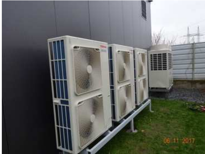
Obr. 4 Kaskáda tří tepelných čerpadel a chiller, Casino Magic Planet Gold Vestec [3.8]
