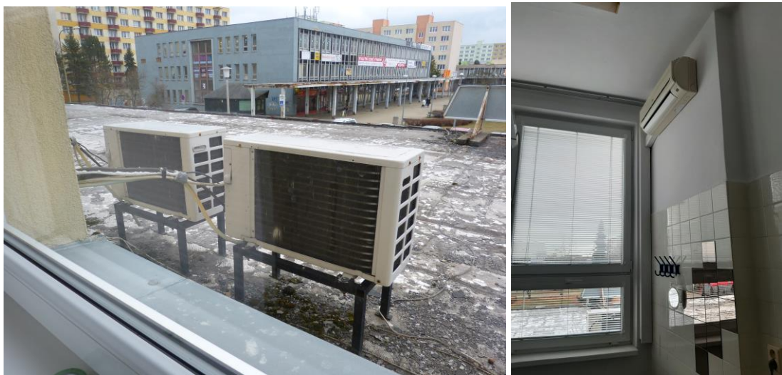
Obr. 9 Multisplit jednotky na přístřešku před okny 2.NP [6]
