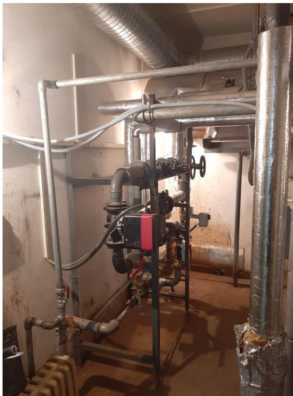
Obr. 8 Výměňková stanice v tech. místnosti [3]
