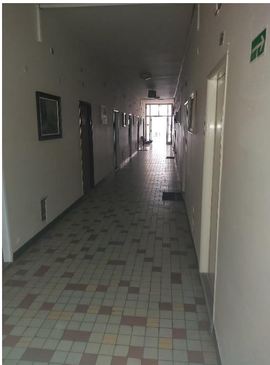
Obr. č. 7 - Podlaha v chodbě budovy (zdroj: vlastní fotodokumentace)
