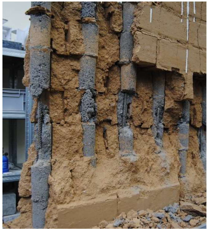
Obrázek 88 - Odhalená výztuž pilíře po odstranění cihel, foto: Petr Čanda
